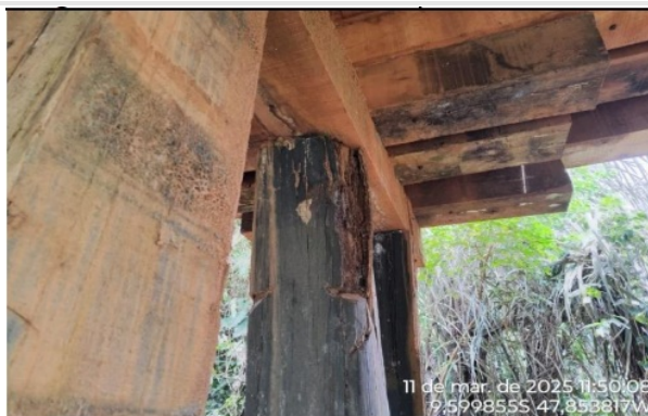
FOTO: 04 - PILAR APODRECIDO
