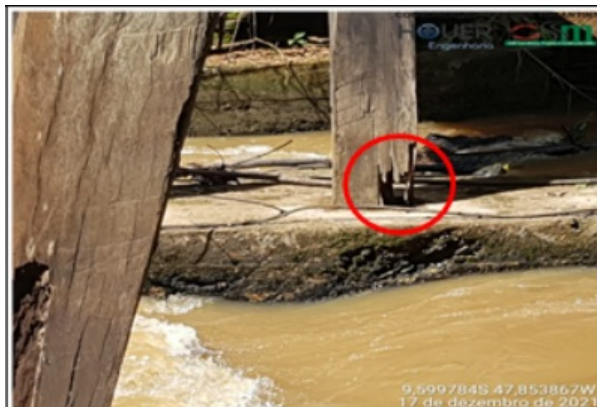
FOTO: 4 - Nível de degradação avançado
