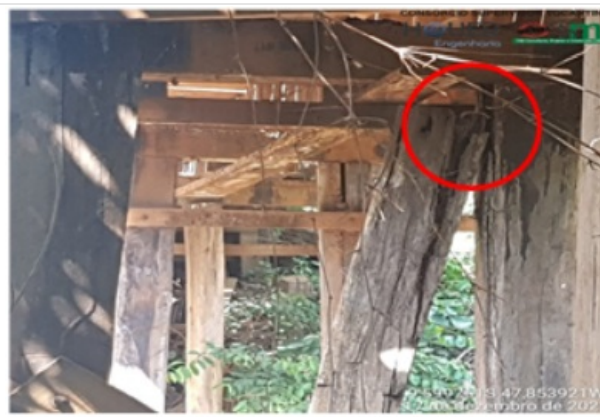
FOTO: 5 - Pilares comprometidos.
