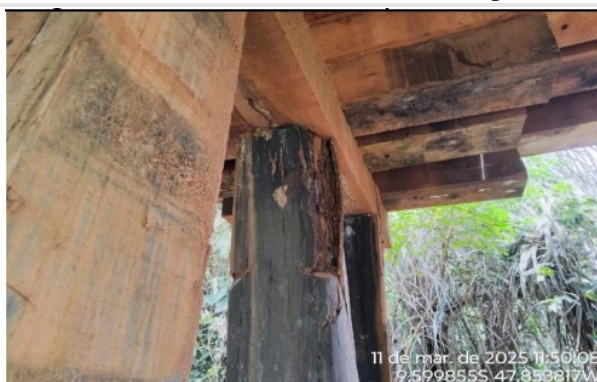
FOTO: 04 - PILAR APODRECIDO
