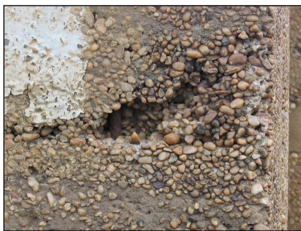
Figura 3.2 – Erosão no pilar
