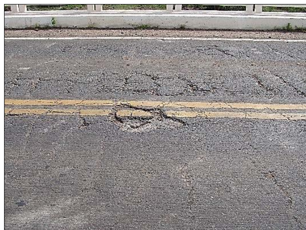
Figura 3.2 – Fissuras no pavimento betuminoso
