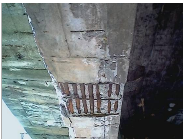
Figura 3.3 – Armaduras oxidadas (viga)
