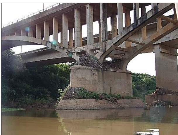
Fig. 3.1 – Galhos sobre bloco/pilar
