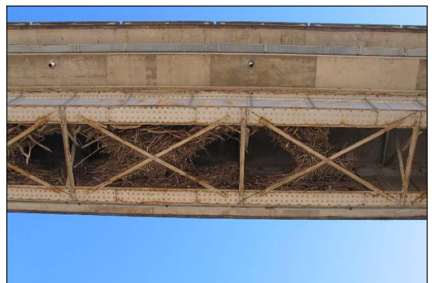
Figura 3.4 – Material retido na estrutura
