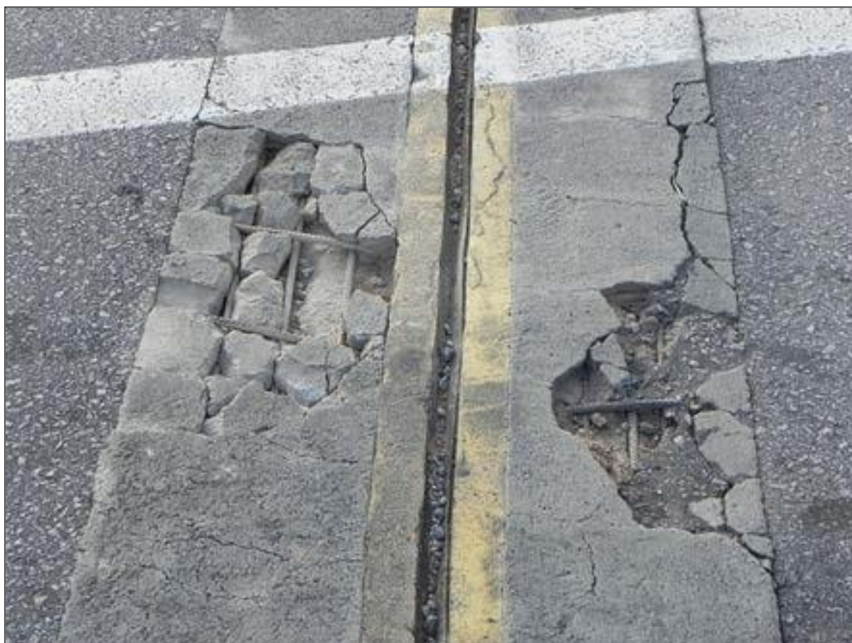
Fig. 3.3 – Berços e lábios poliméricos danificados
