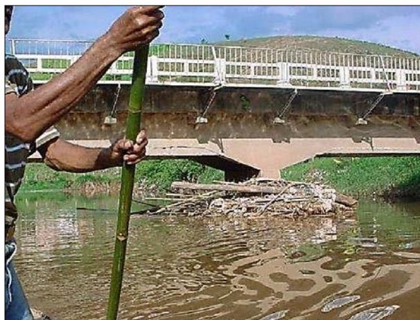
Fig. 3.2 – Troncos/galhos presos à estrutura
