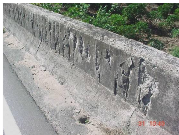
Fig. 3.2 – Deslocamento na barreira rígida
