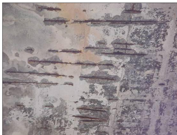
Figura 3.4 – Armaduras oxidadas (laje)
