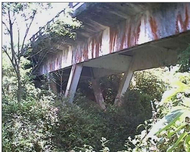
Figura 3.1 – Manchas de corrosão
