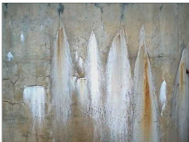
Figura 3.1 – Eflorescências em viga
