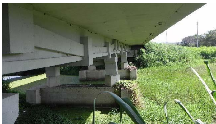
Fig. 3.3 – Vegetação sobre os blocos de fundação
