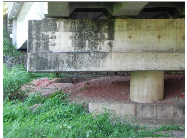
Figura 3.2 - Sujeira e manchas na travessa
