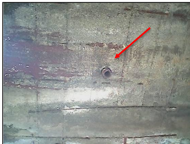
Fig. 3.2 – Dreno de diâmetro insuficiente
