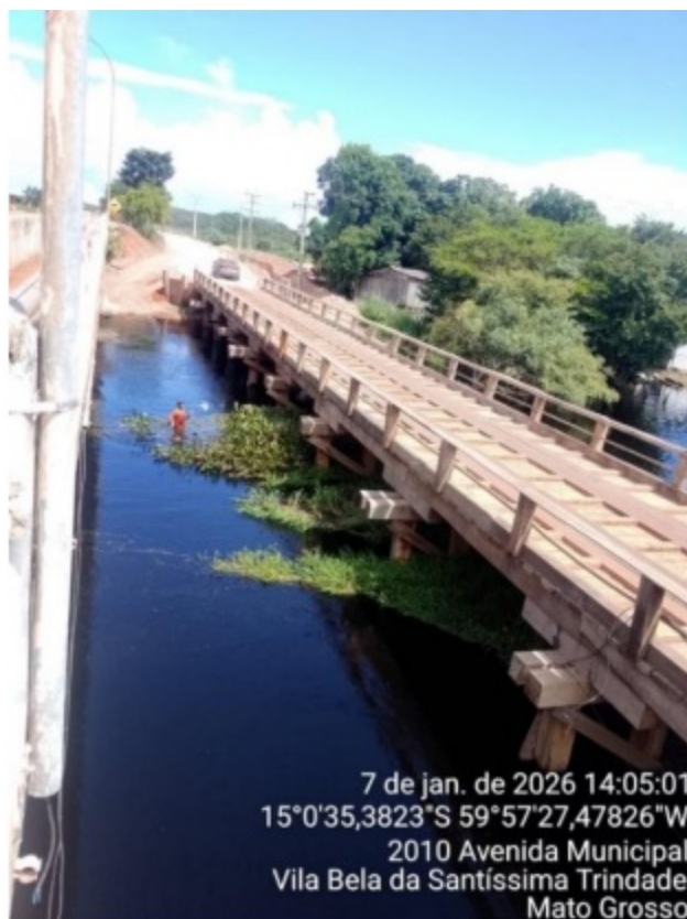
FOTO 2 – NÍVEL D'ÁGUA ELEVADO ENCOBRINDO A PLATAFORMA DE ACESSO.
