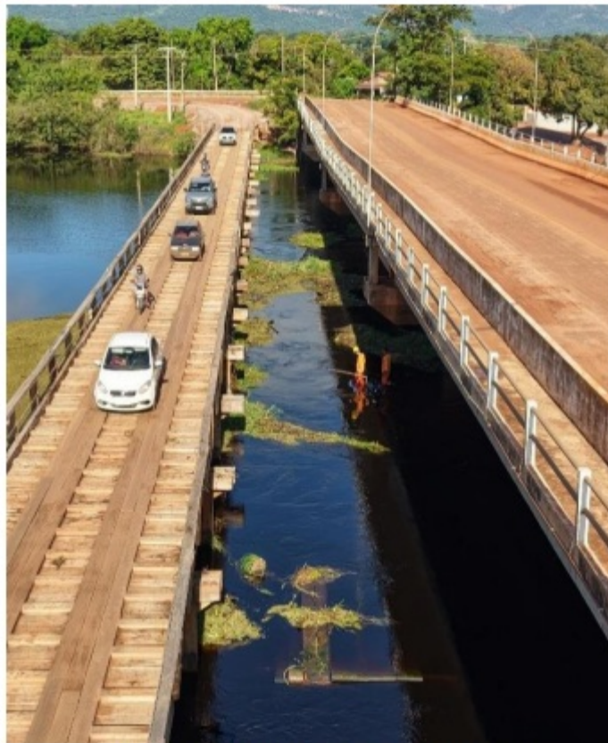
FOTO 1 – NÍVEL D'ÁGUA ELEVADO ENCOBRINDO A PLATAFORMA DE ACESSO.
