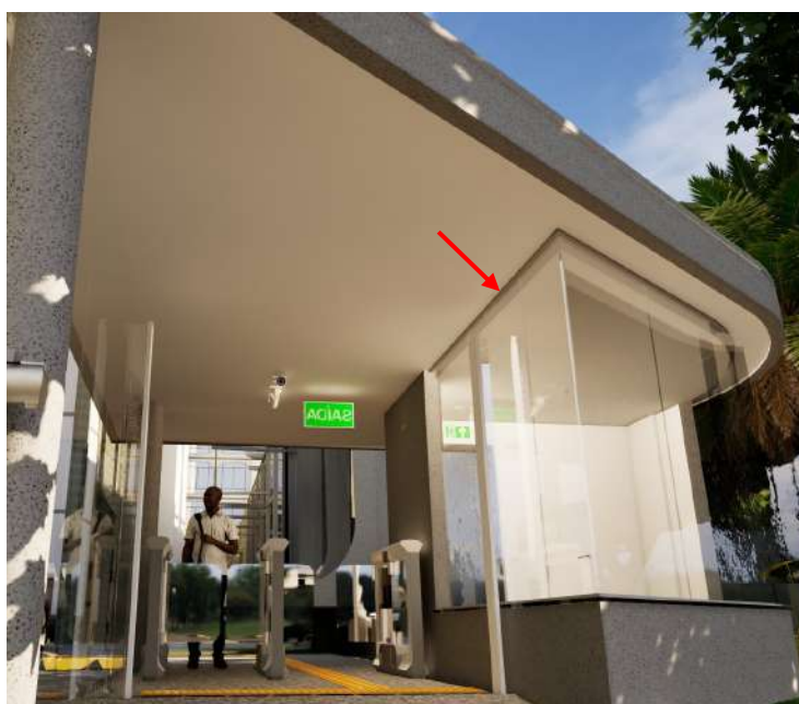
Vista do forro da guarita e a indicação da dilatação
