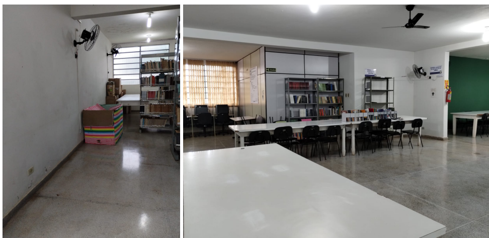
Imagens 27 e 28: Pontos de tomada insuficientes
