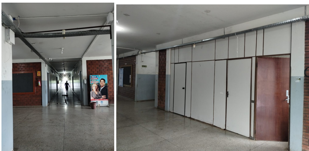
Imagens 11 e 12: Eletrocalhas em situação inadequada e desorganizadas
