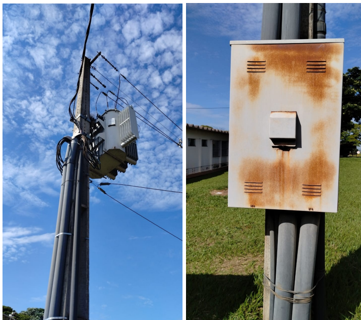
Imagens 09 e 10: Postes com fiação antiga
