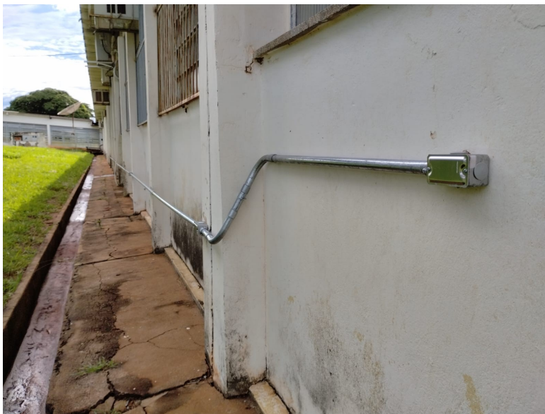
Imagem 29: foi necessário puxar a fiação externamente para que algumas salas do bloco didático A consigam funcionar corretamente por conta da demanda do ar condicionado
