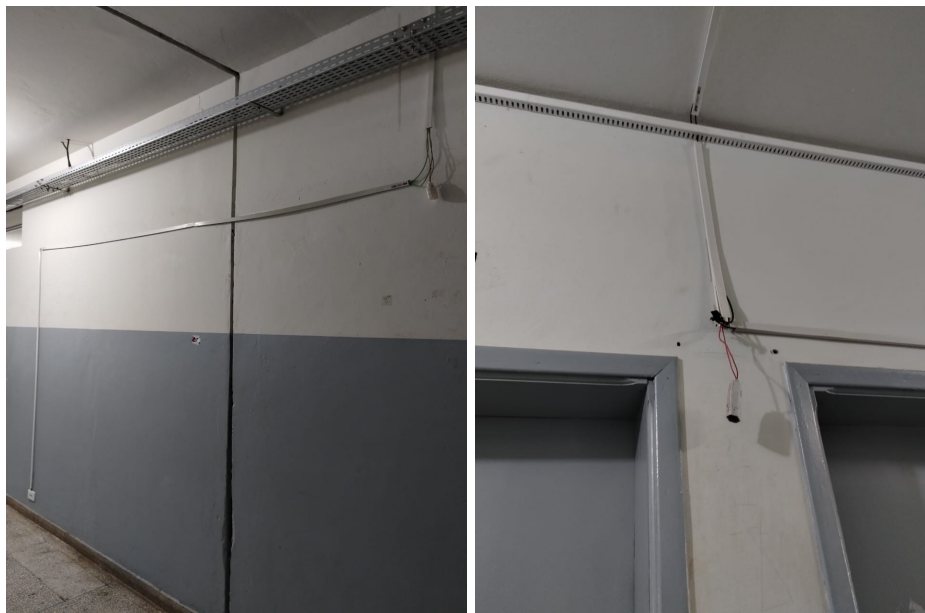
Imagens 17 e 18: Canaletas danificadas
