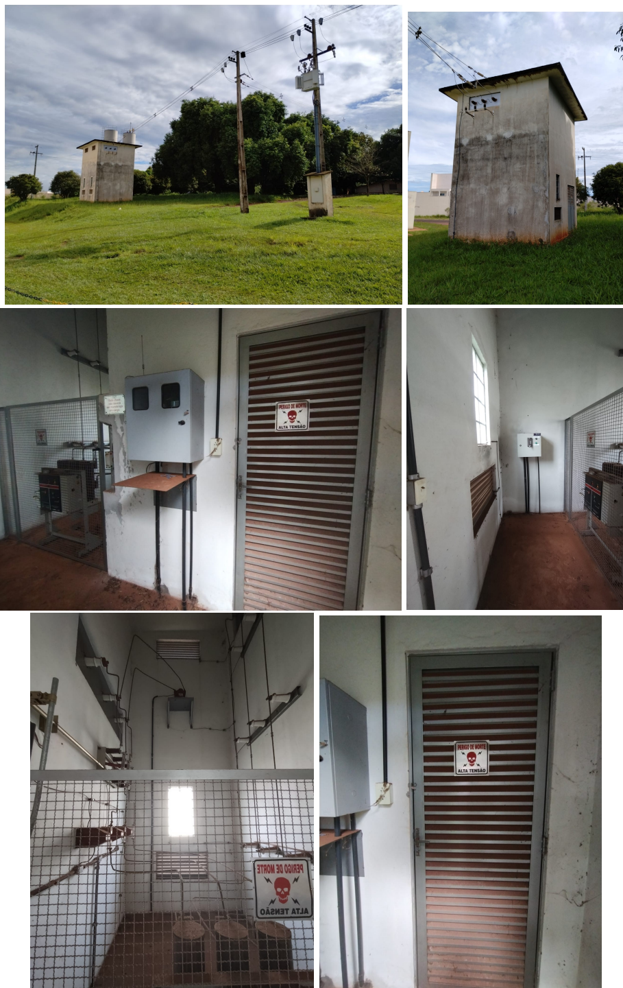
Imagens 03 a 08: Entrada da casa de força do transformador
