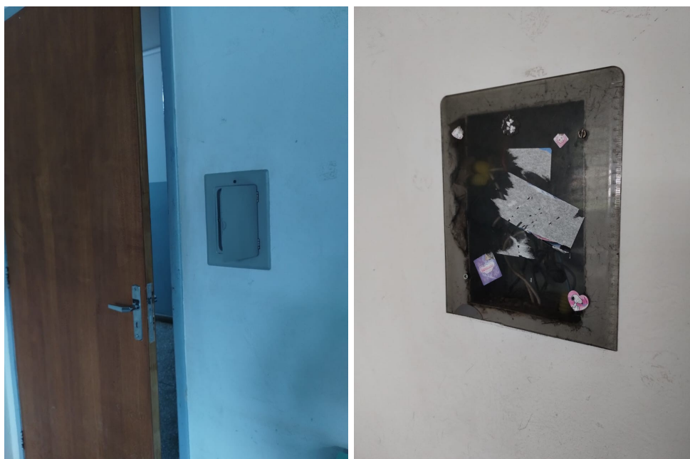
Imagens 19 e 20: Quadros em situação inadequada
