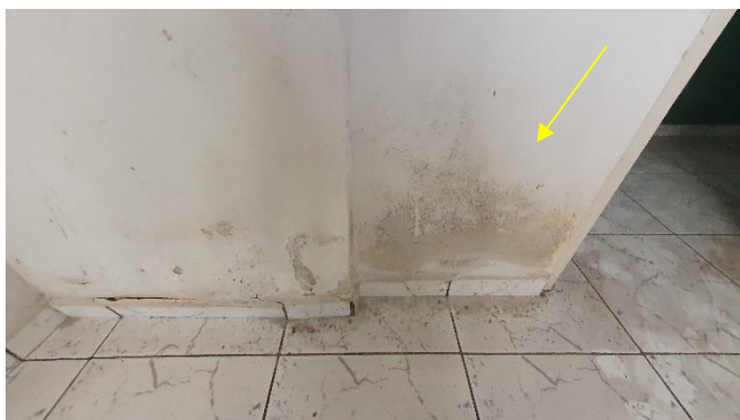
VISTA DE DESCAMAÇÃO DO REVESTIMENTO DAS PAREDES
