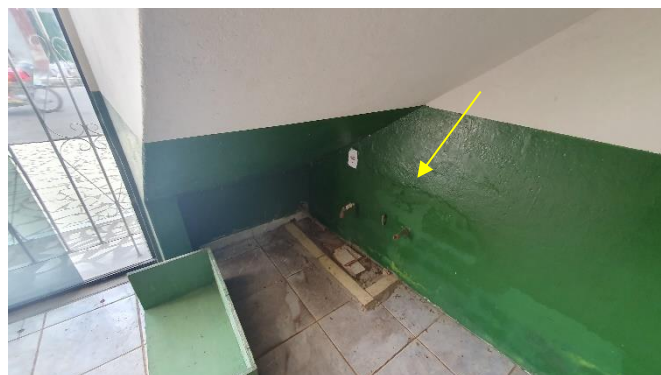
VISTA DO ESPAÇO AONDE FICA A BOMBA D'ÁGUA
