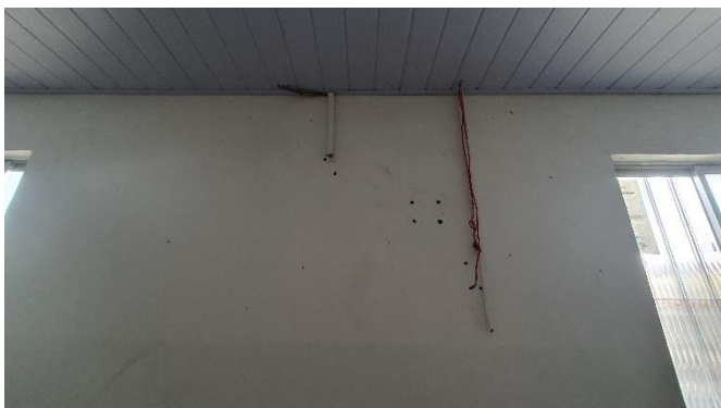
VISTA DAS INSTALAÇÕES ELÉTRICAS APARENTES
