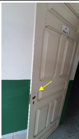
VISTA DA AUSÊNCIA DE FECHADURA NA PORTA
