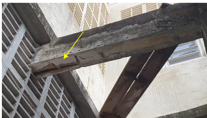
VISTA DE ARMADURAS EXPOSTAS NA VIGA
