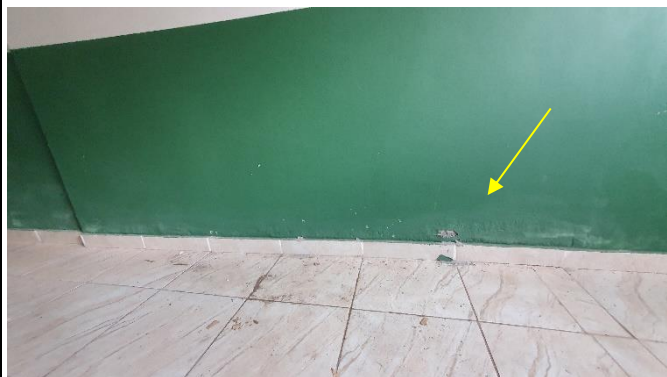
VISTA DE DESCAMAÇÃO DO REVESTIMENTO DAS PAREDES
