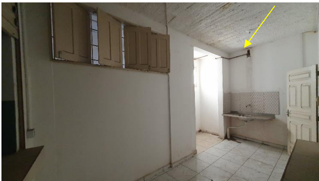
VISTA DA COPA, COM INSTALAÇÕES HIDRÁULICAS E ELÉTRICAS APARENTES
