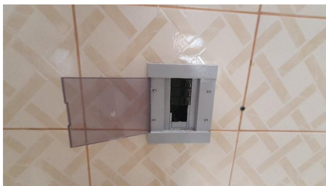
VISTA DO QUADRO ELÉTRICO DO PAV. SUPERIOR
