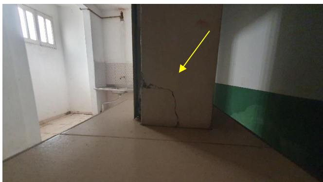
VISTA DE RACHADURA NA PAREDE
