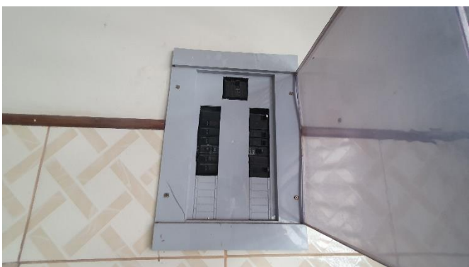
VISTA DO QUADRO ELÉTRICO DO PAV. SUPERIOR
