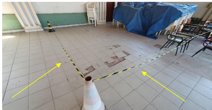
Vista do Descolamento do Piso do Auditório
