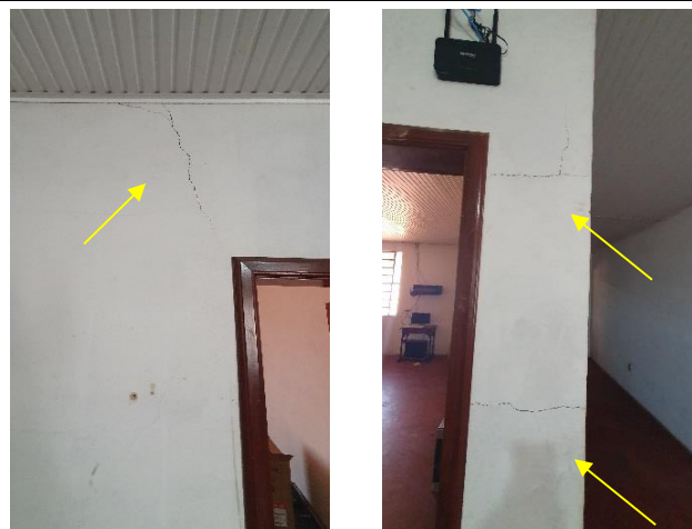
Vista da Presença de Trincas nas Paredes
