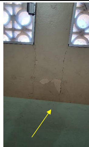
Vista das Trincas nas Paredes
