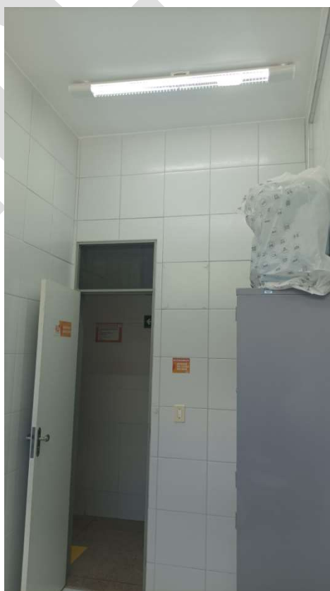
Foto 16- Banheiro. RU da UFCG/CDSA. Fonte: O AUTOR
