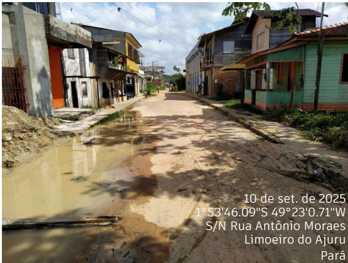
FOTO 18: RUA ANTÔNIO MORAES , trecho onde nota-se a irregularidade da rua, presença de lama e pontos de alagamento.
