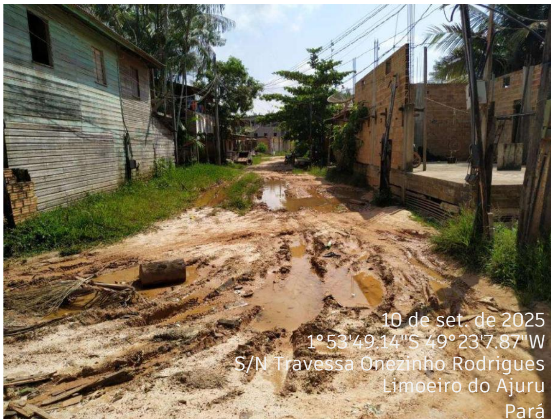
FOTO 02: TV. ONEZINHO RODRIGUES (próximo à rua nova) trecho onde percebe-se a irregularidade da via, presença de lama e pontos de alagamento.
