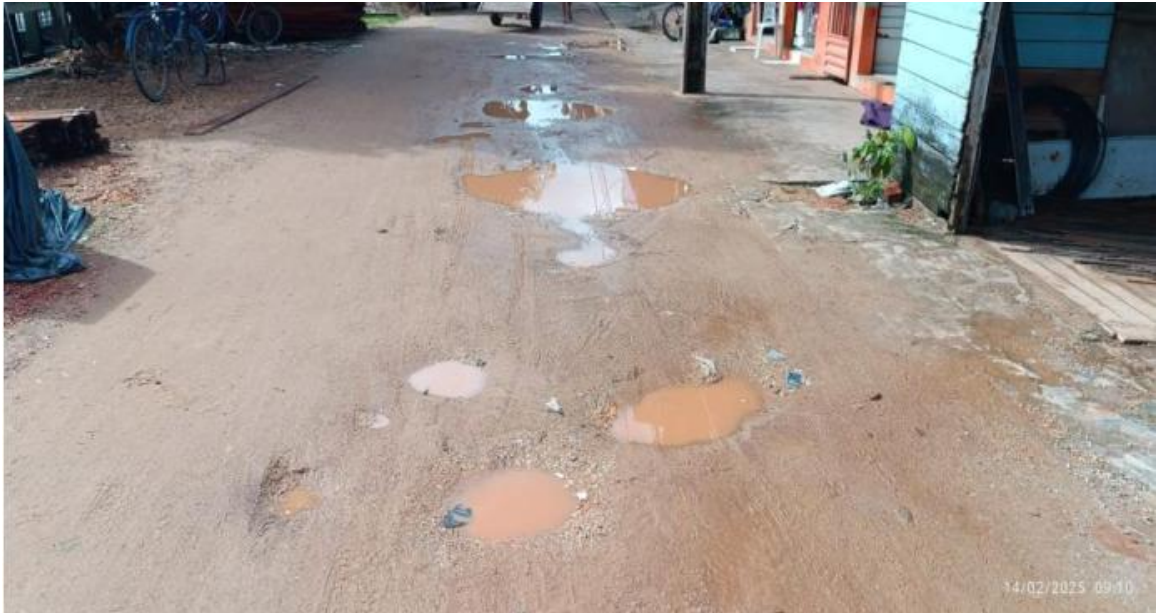
FOTO 14: RUA MARECHAL RONDON , trecho onde nota-se a irregularidade da via, presença de lama e pontos de alagamento.
