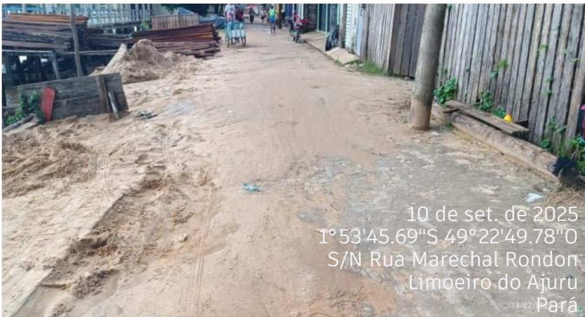
FOTO 12: RUA MARECHAL RONDON, trecho onde percebe-se a irregularidade da via.
