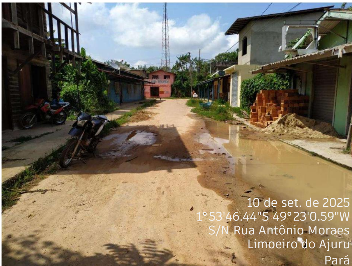
FOTO 17: RUA ANTÔNIO MORAES , trecho onde percebe-se a irregularidade da via, presença de lama, existência de vegetação no leito carroçável e pontos de alagamento.
