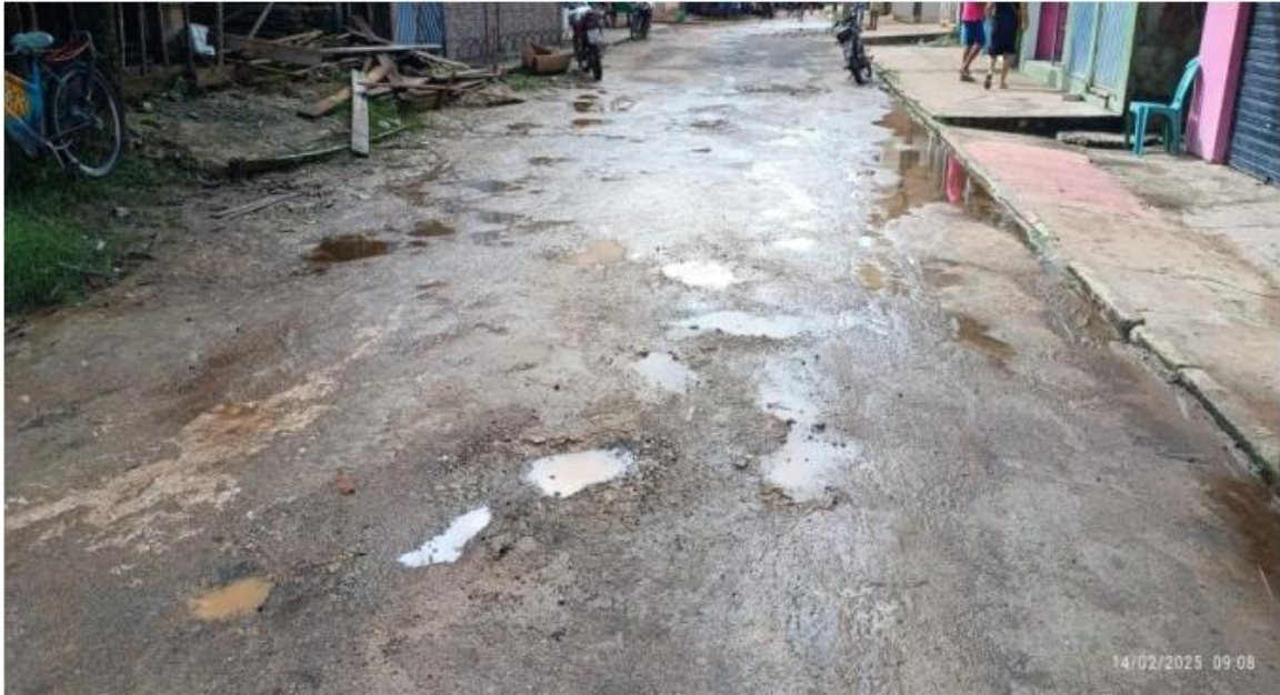
FOTO 09: RUA MARECHAL RONDON , trecho onde nota-se a irregularidade da via, presença de lama e pontos de alagamento.
