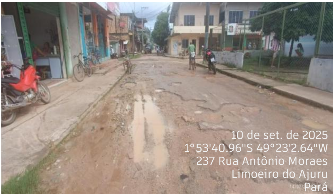
FOTO 20: RUA ANTÔNIO MORAES , trecho onde nota-se perceber a irregularidade da via, presença de lama e pontos de alagamento.
