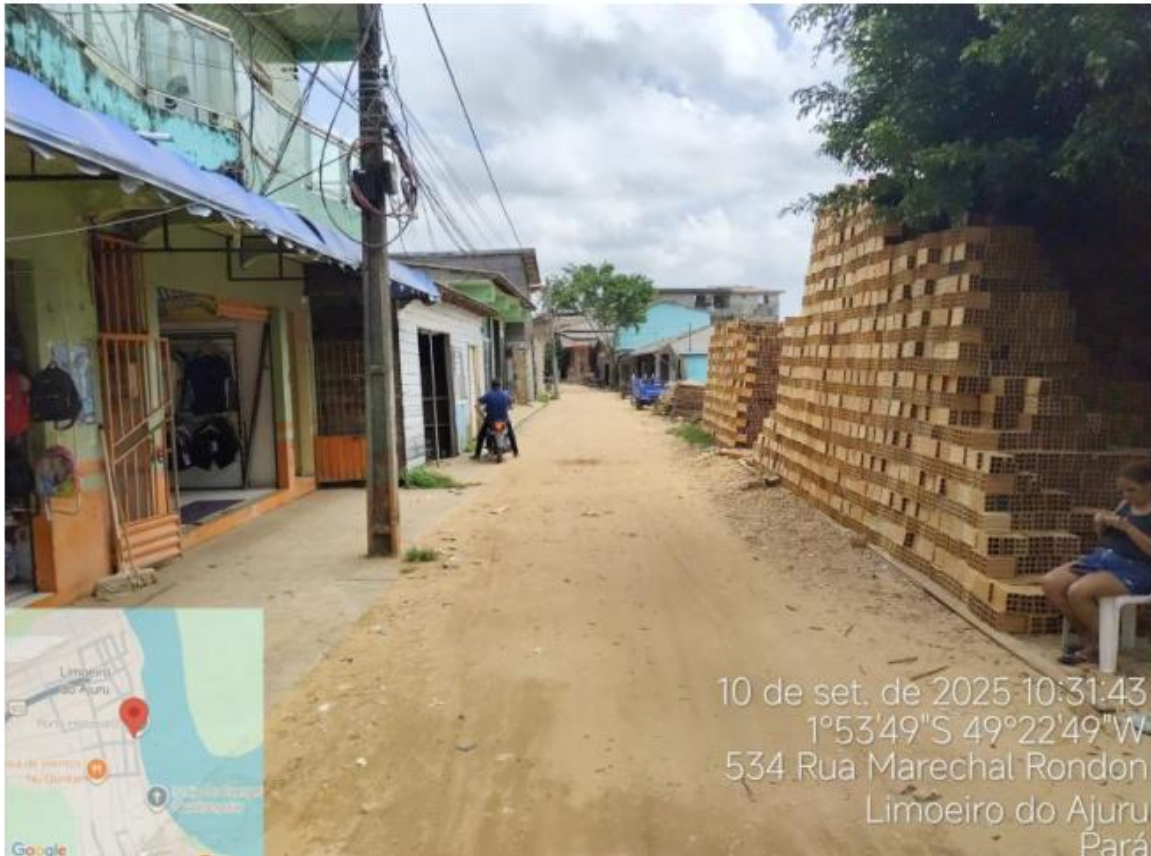
FOTO 16: RUA MARECHAL RONDON , trecho da via sem a presença de asfaltamento.
