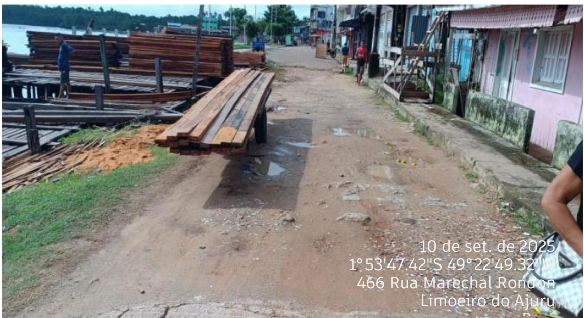
FOTO 14: RUA MARECHAL RONDON , trecho onde nota-se a irregularidade da via, presença de lama e pontos de alagamento.
