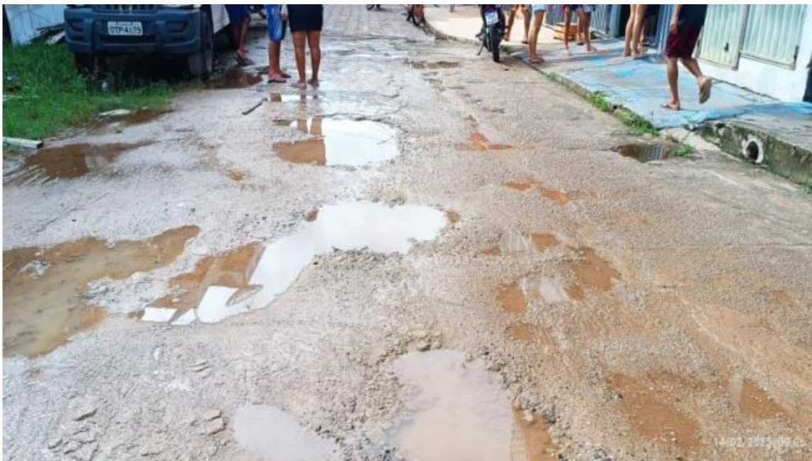
FOTO 07: RUA MARECHAL RONDON , trecho onde percebe-se a irregularidade da via, presença de lama e pontos de alagamento.
