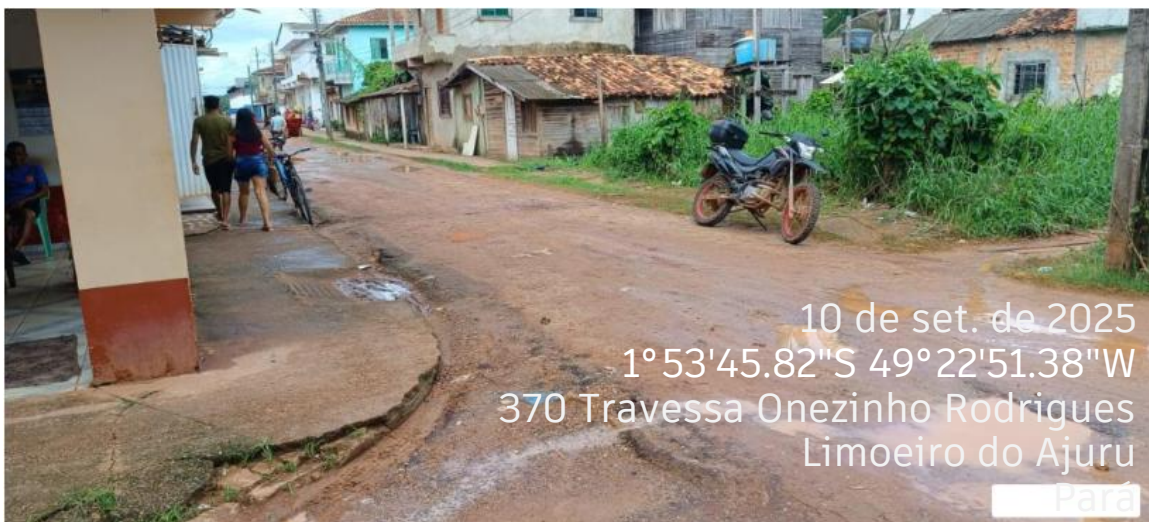
FOTO 04: TV. ONEZINHO RODRIGUES , trecho onde nota-se a irregularidade da via, presenca de lama e pontos de alagamento.
