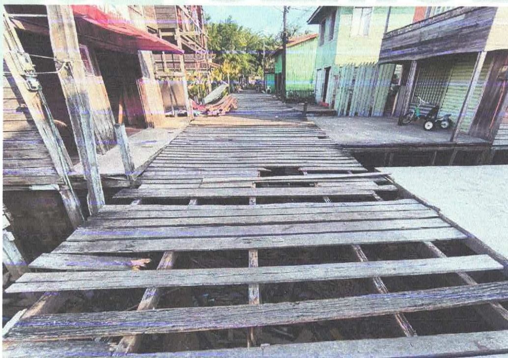
Foto 05: Assoalho e estrutura em situação crítica.
