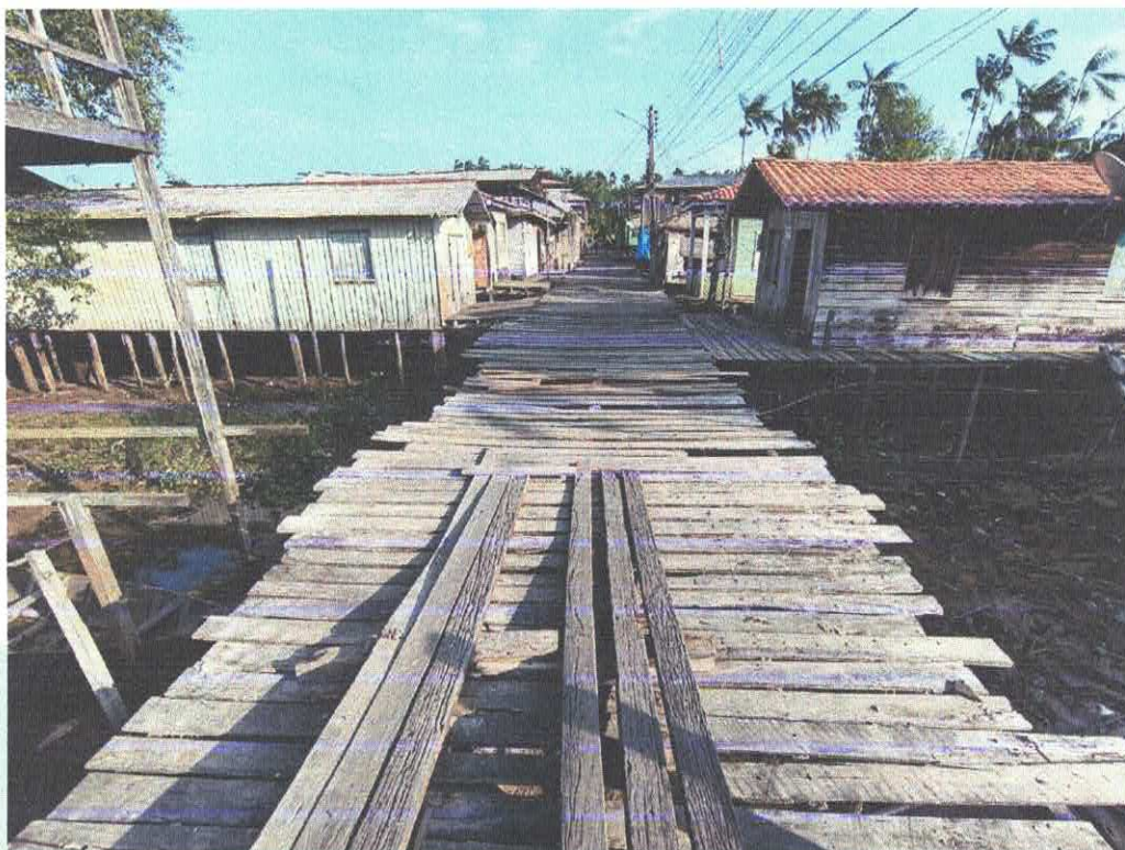
Foto 06: Assoalho e estrutura em situação crítica.
