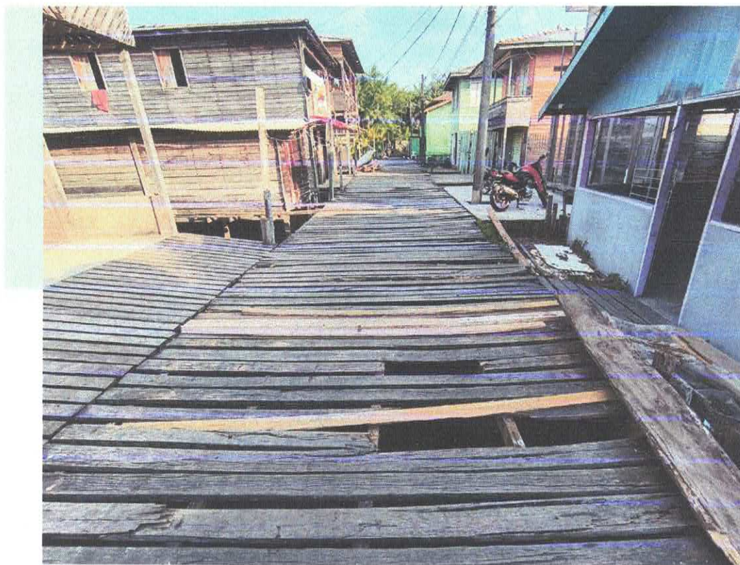
Foto 01: Assoalho e frechais danificados.
