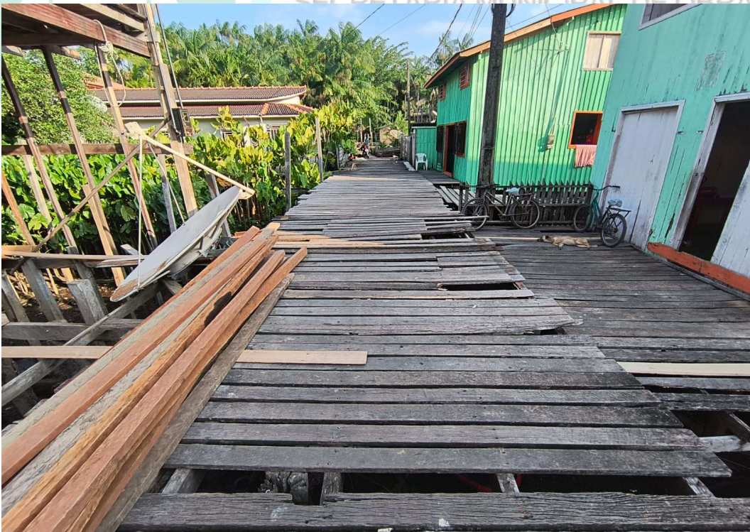
Foto 07: Assoalho e estrutura em situação crítica.
