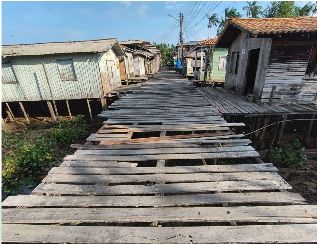
Foto 02: Assoalho e estrutura em situação crítica.
