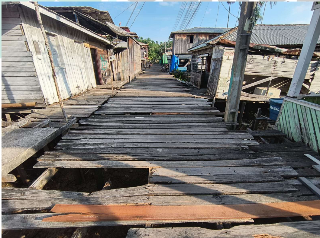
Foto 03: Assoalho e estrutura em situação crítica.
