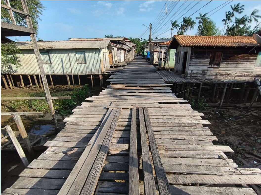
Foto 06: Assoalho e estrutura em situação crítica.
