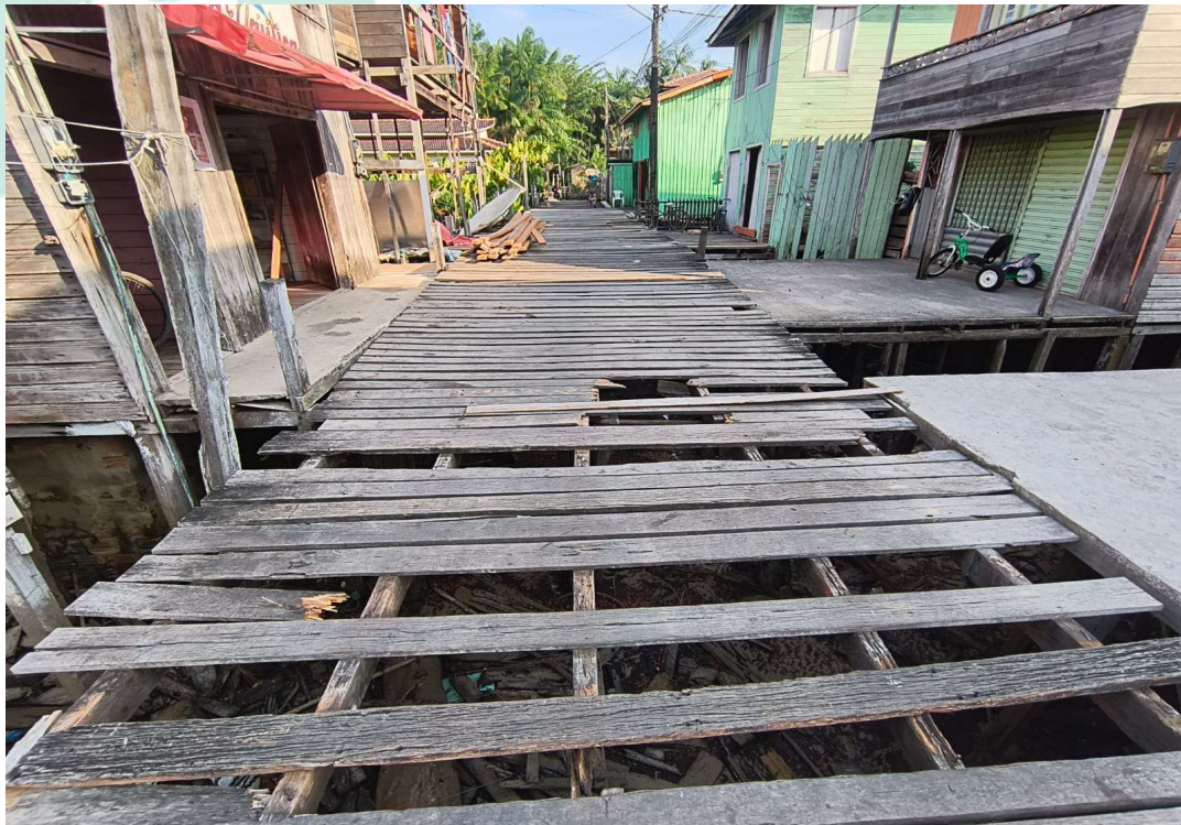
Foto 05: Assoalho e estrutura em situação crítica.
