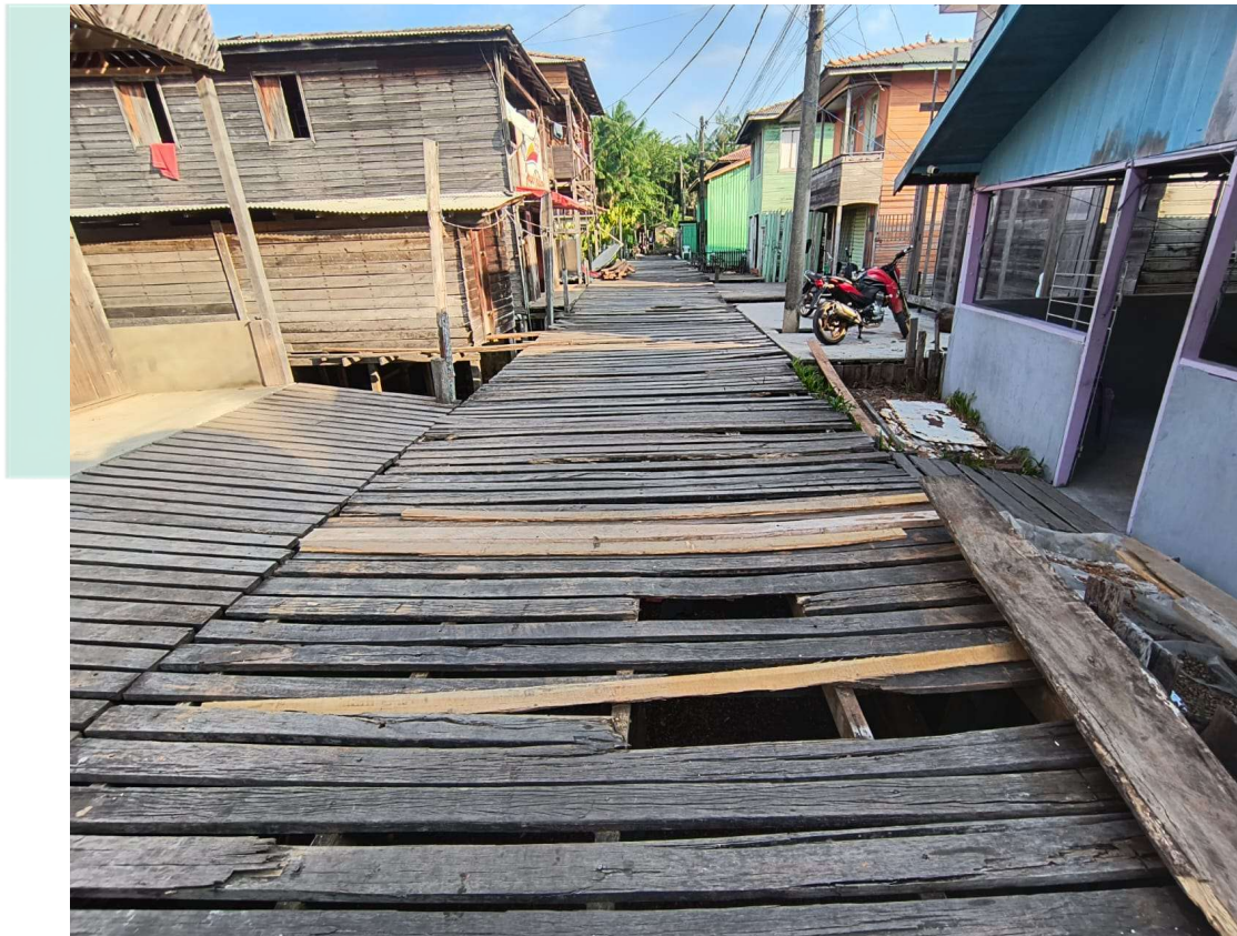
Foto 01: Assoalho e frechais danificados.
