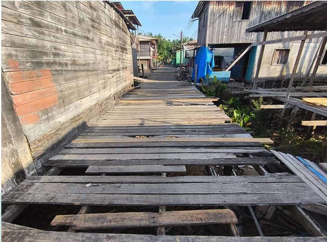
Foto 04: Assoalho e estrutura em situação crítica.
