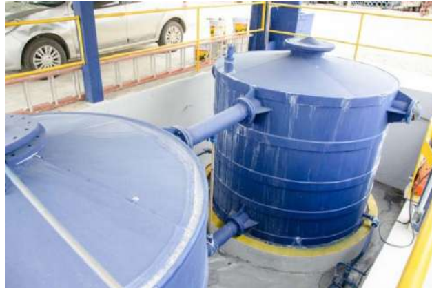
Figura 29 – Casa de química da ETA
