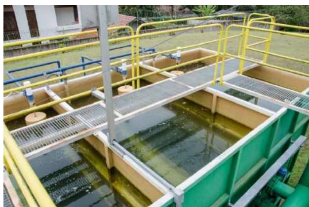
Figura 22 – Filtros da ETA compacta
