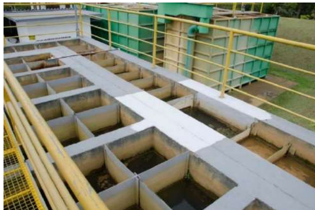
Figura 12 – Floculador da ETA Convencional
