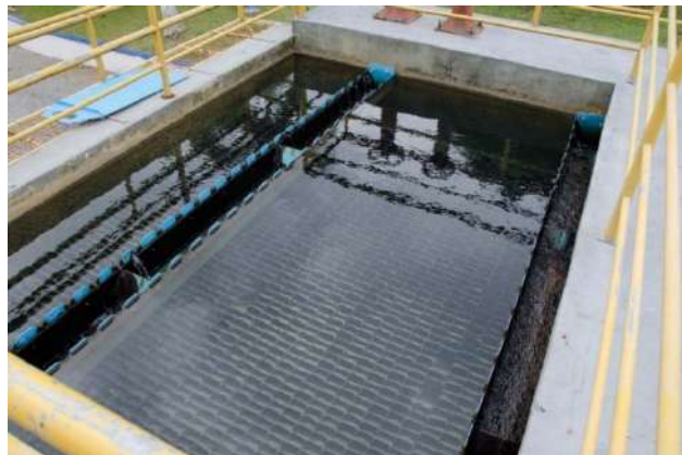
Figura 14 – Decantador 02 da ETA convencional
