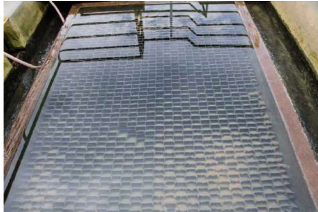
Figura 13 – Decantador 01 da ETA convencional
