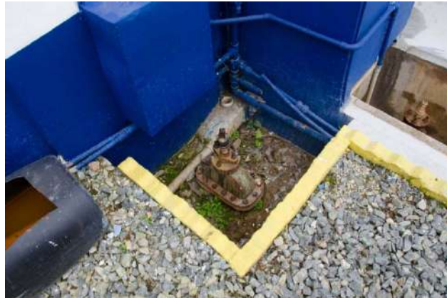
Figura 5 – Entrada de água bruta na ETA convencional
