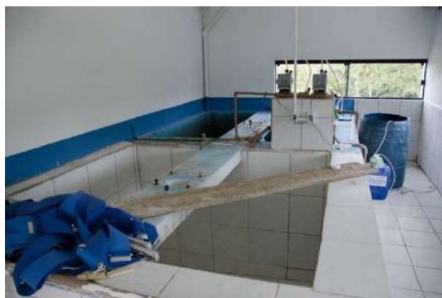
Figura 25 – Casa de química da ETA
