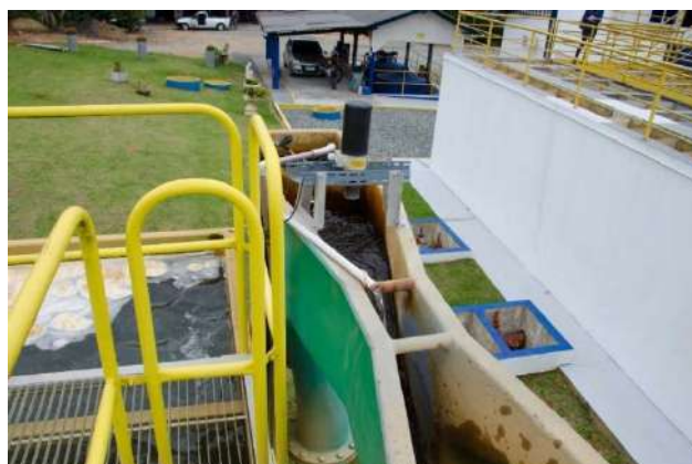
Figura 19 – Canal de entrada na ETA convencional
