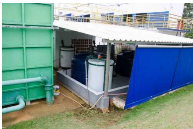
Figura 28 – Casa de química da ETA
