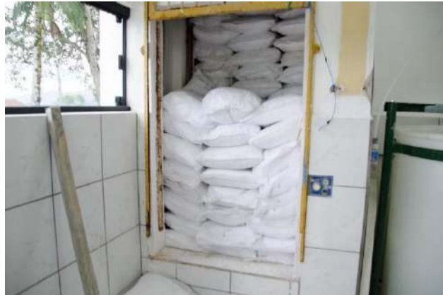
Figura 26 – Casa de química da ETA
