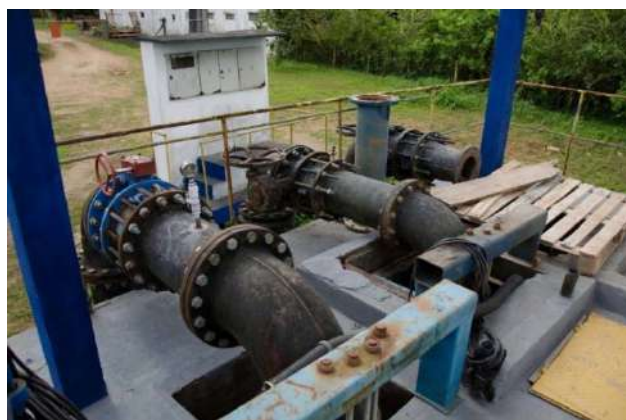
Figura 8 – Vista das tubulações de saída das bombas
