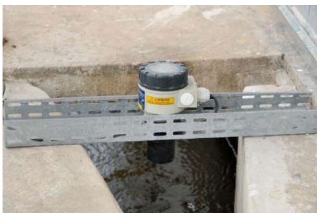
Figura 9 – Canal de entrada na ETA convencional
