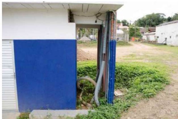
Figura 13 – Cabeamentos expostos na captação
