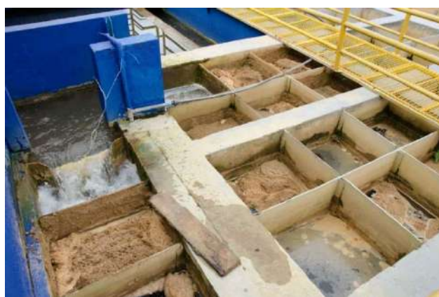
Figura 10 – Floculador da ETA Convencional
