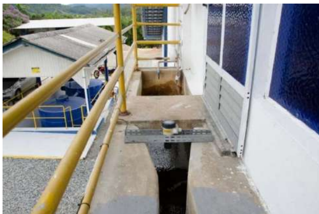
Figura 8 – Canal de entrada na ETA convencional
