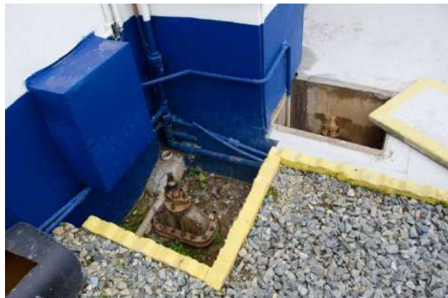
Figura 6 – Entrada de água bruta na ETA convencional
