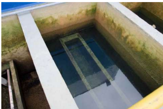
Figura 16 – Filtros da ETA convencional
