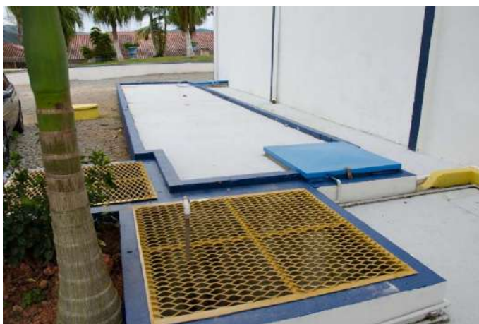
Figura 17 – Tanque de contato da ETA convencional
