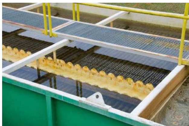
Figura 21 – Decantador 01 da ETA compacta
