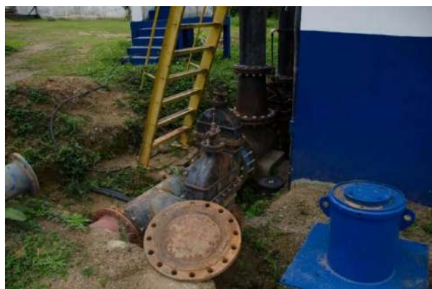
Figura 11 – Vista das tubulações de saída das bombas
