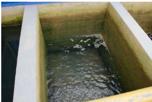
Figura 15 – Filtros da ETA convencional
