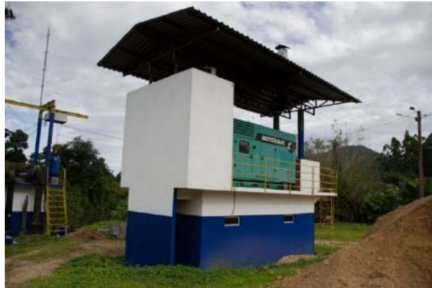
Figura 12 – Vista externa do gerador
