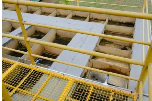
Figura 11 – Floculador da ETA Convencional
