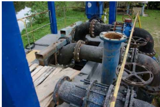
Figura 10 – Vista das tubulações de saída das bombas
