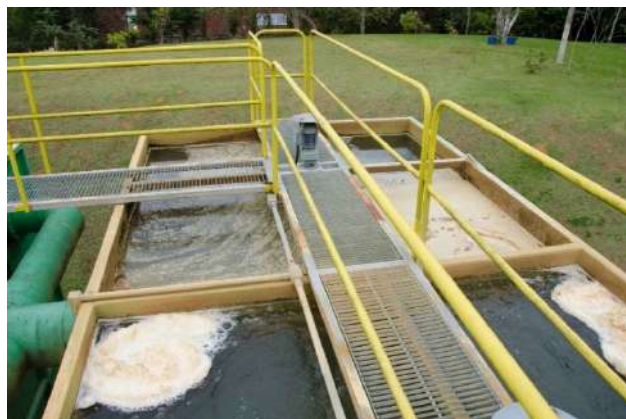
Figura 20 – Floculador da ETA Compacta
