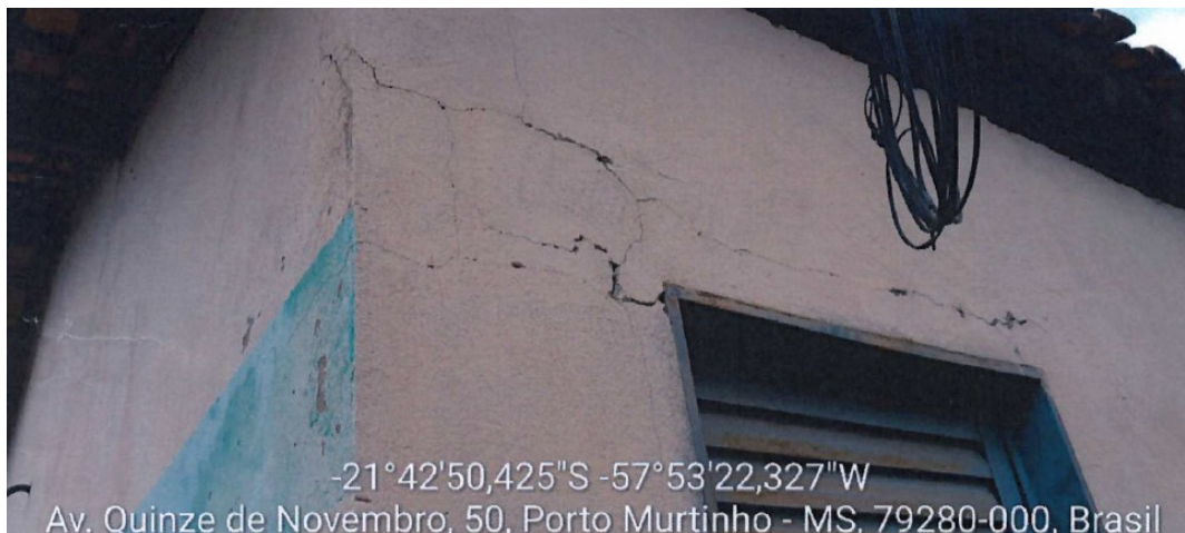
Figura 2. Unidade habitacional que necessita ser demolida e reconstruída.
