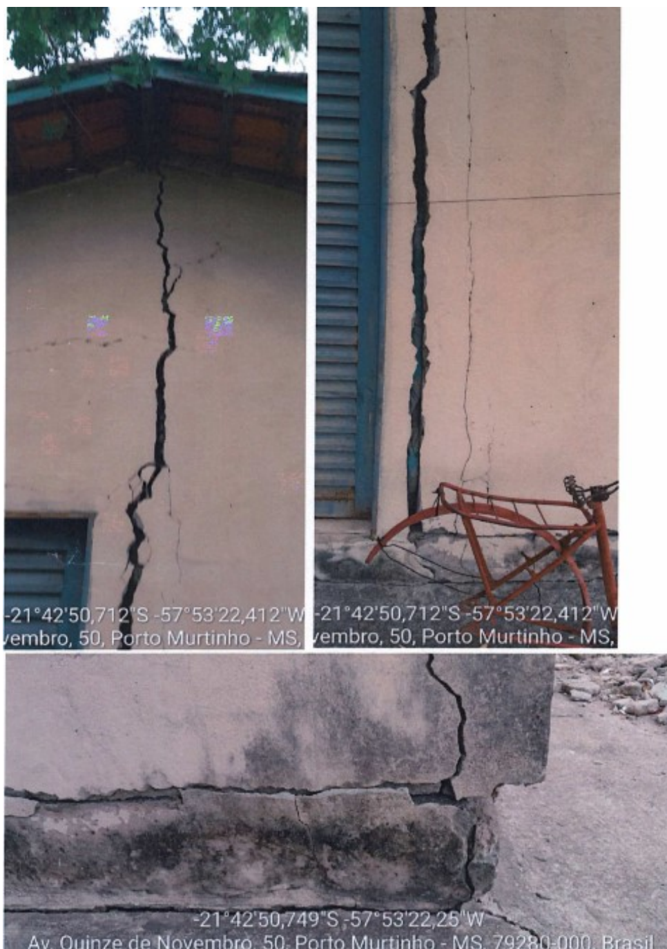
Figura 3. Unidade habitacional que necessita ser demolida e reconstruída.
