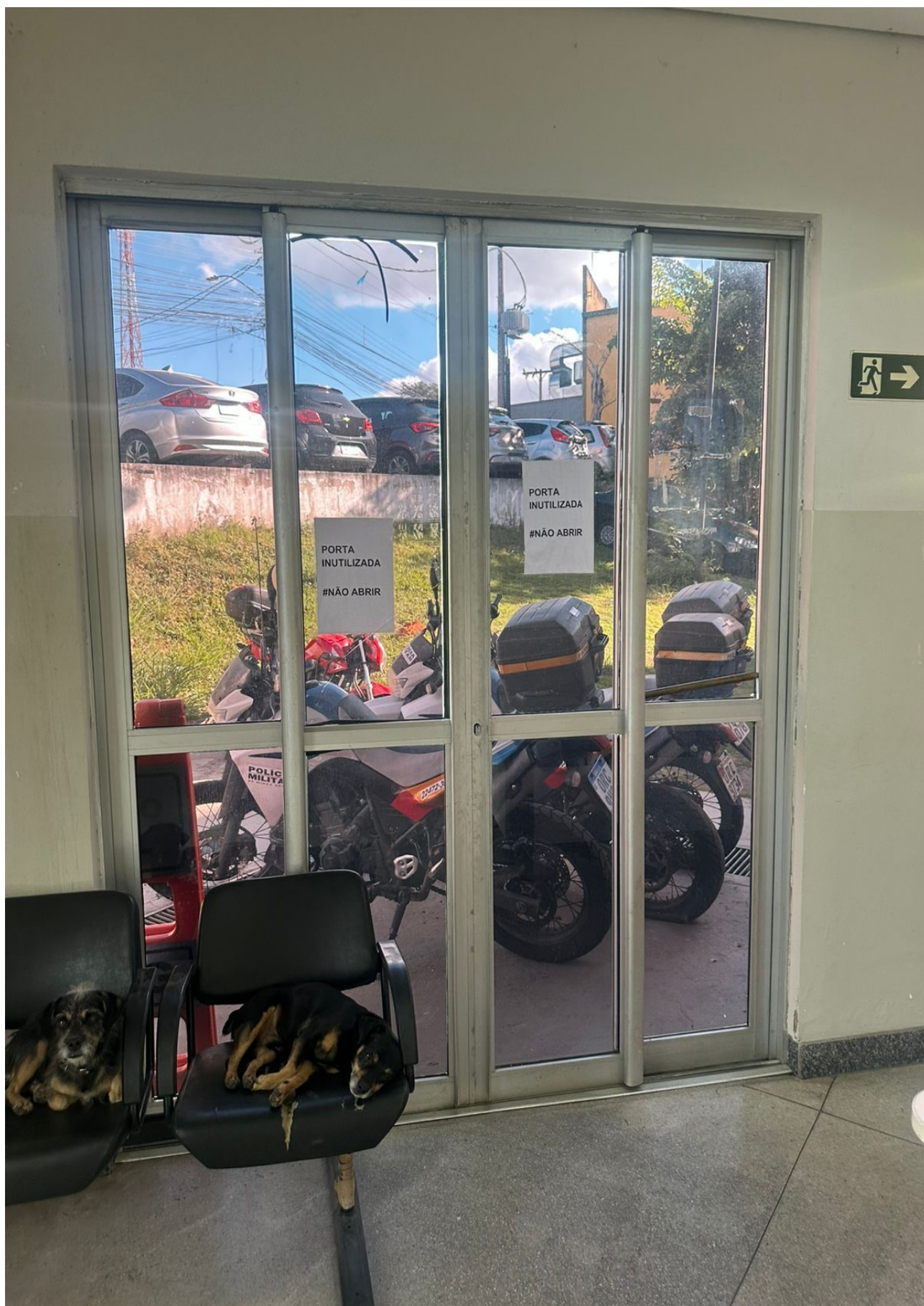
Figura 6 - Porta de esquadria metálica sem utilização
