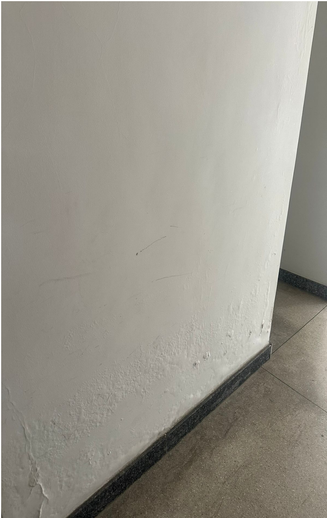
Figura 3 - Parede do corredor - Pavimento térreo
