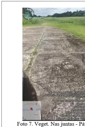
Foto 7. Veget. Nas juntas - Pátio
