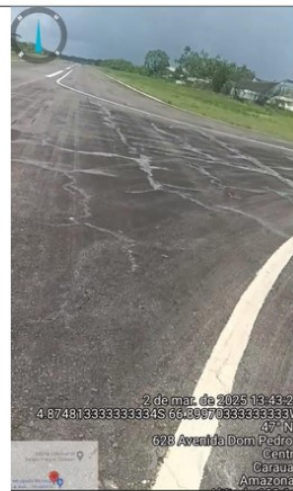
Foto 4. Fissuras e subida de finos-PPD
