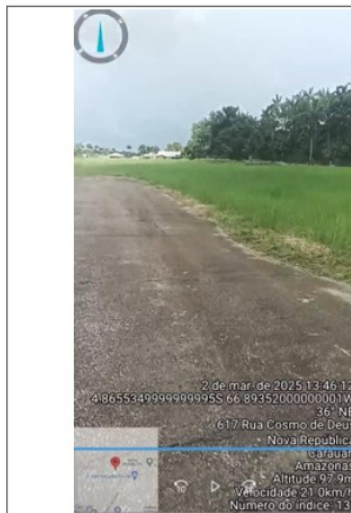
Foto 3. Faixa de pista faltando limpeza
