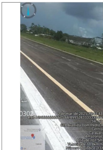
Foto 1. Fissura com subida de finos-PPD
