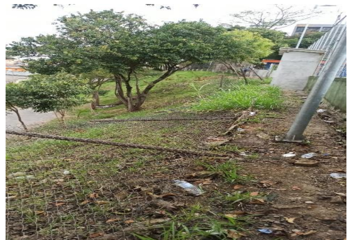
ALAMBRADO DE LIMITE DO TALUDE
