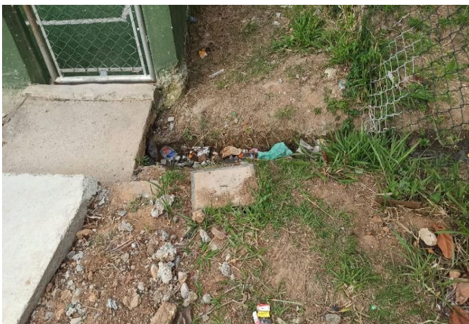
DESNÍVEL DE PASSEIO EM CONCRETO
