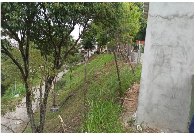
ALAMBRADO DE LIMITE DO TALUDE
