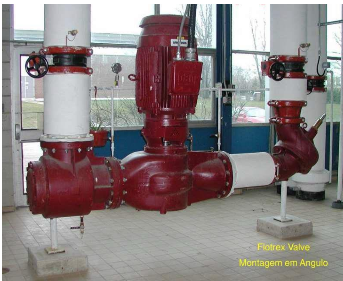
Figura 4 - Imagem de uma montagem de BAG's in-line
