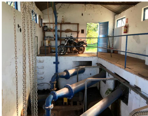
Figura 03- Vista interna da EEAB 1. Necessidade de ampliações e melhorias.
