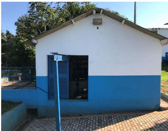
Figura 02 - EEAB 01 - Vista do Sistema de Remoção das bombas da Elevatória de Água Bruta
