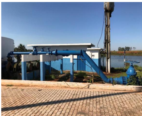
Foto 12 - Vista da Elevatória de Água tratada
