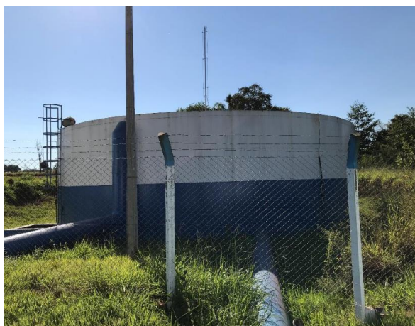
Foto 13 - Reservatório metálico de acumulação existente - 750m 3 .
