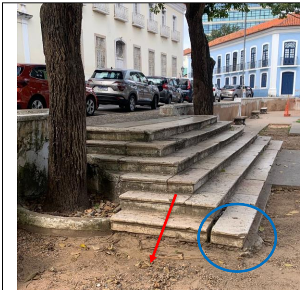
Figura 1: Detalhe destacado pela seta vermelha da projeção das raízes para além do solo, o que acarretou a ruptura do piso de concreto de alta resistência. Outro dano é o deslocamento do degrau mais baixo da estrutura da escada (círculo azul).
