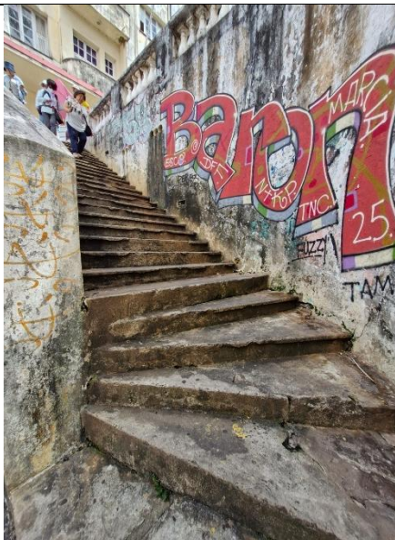
Figura 2: situação atual da escadaria, pisos em concreto danificado, pichações nas paredes, além de que o espaço vem sendo utilizado como banheiro à céu aberto.
