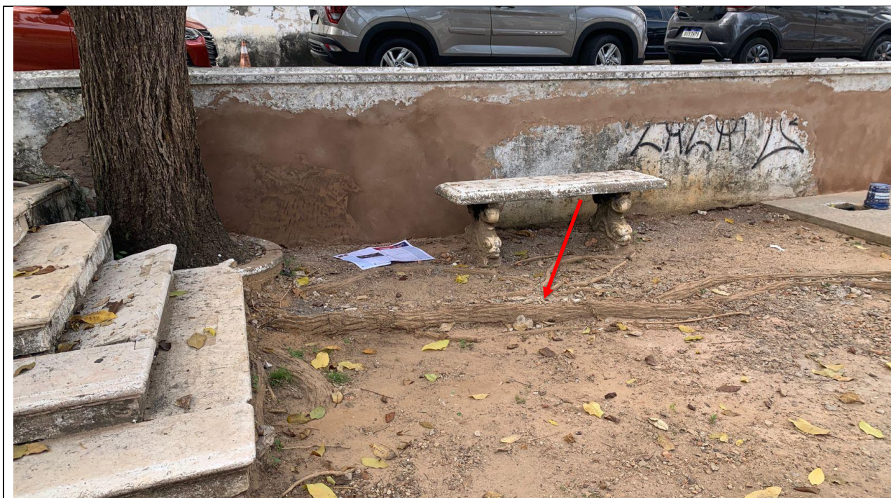
Figura 4: imagem que revela a extensão da raiz e sua protuberância em relação ao solo. Toda esta área apresentou ruptura do piso industrial.
