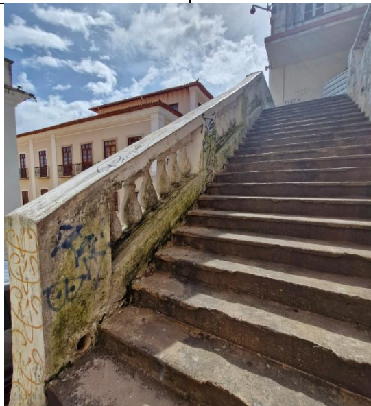
Figura 3: vista do guarda corpo de balaustres existentes, também bastante degradado, necessitando de manutenção e pintura.
