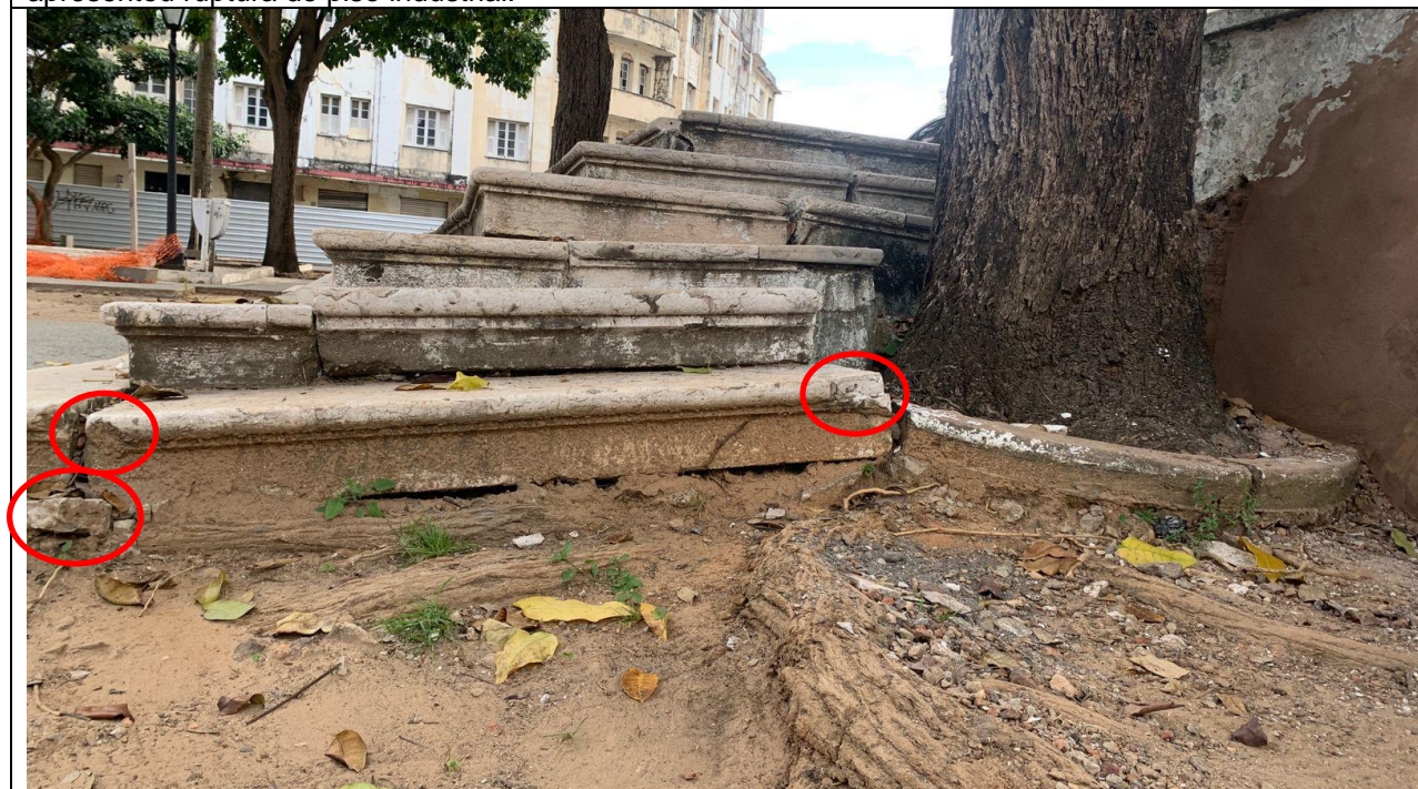
Figura 5: vista lateral direita da escadaria no nível do piso da praça. Este lado é o mais danificado pelo crescimento das raízes, pois provocou deslocamento, desnivelamento e quebra do piso (destaques em vermelho) em mármore de lioz.
