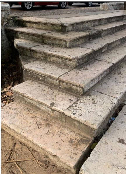
Figura 2: o deslocamento do degrau mais baixo da estrutura da escada.
