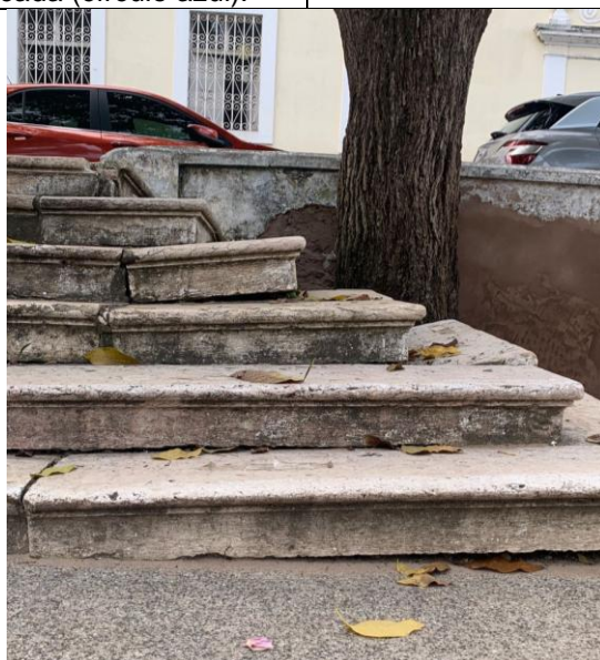
Figura 3: vista frontal direita da escadaria no nível do piso da praça. Este lado é o mais danificado pelo crescimento das raízes, pois provocou deslocamento, desnivelamento e quebra do piso em mármore de lioz.
