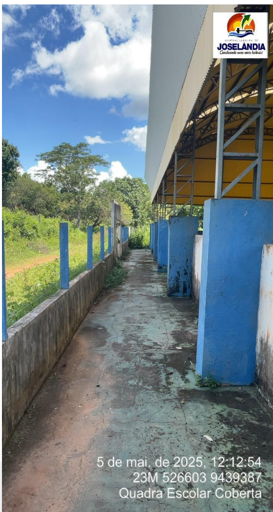
Foto 5 – Lateral da quadra com fisuras e pintura comprometida.
