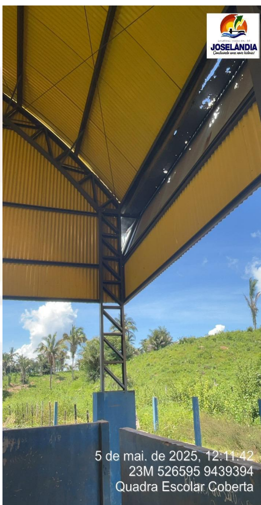
Foto 8 - Calhas obstruídas e com furos
