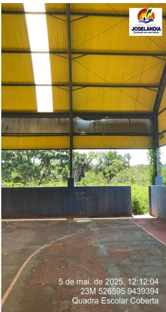
Foto 7 – Cobertura aberta e soltas.
