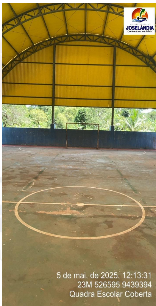
Foto 4 - Piso com fissuras, buracos.
