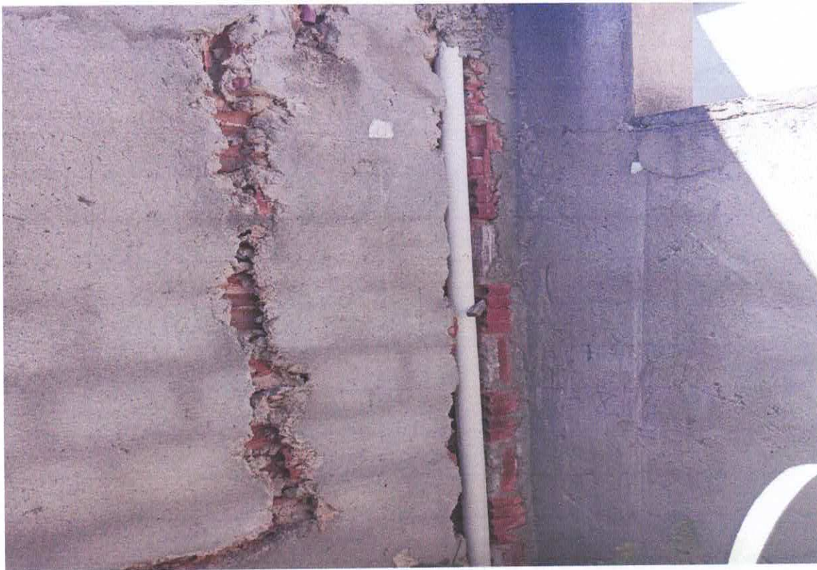
Figura 7 – tubulação exposta . Fonte: elaboração própria
