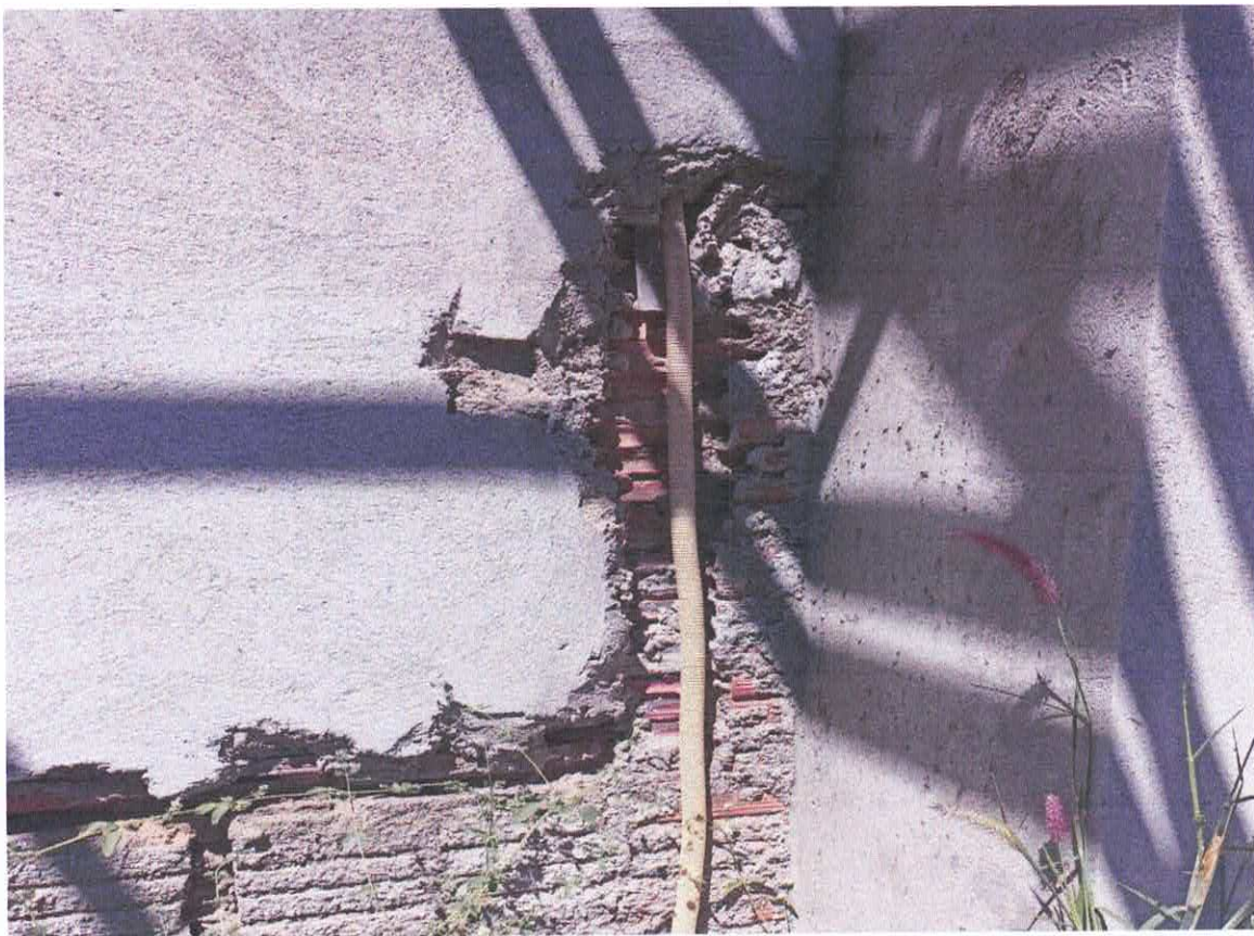
Figura 5 – Eletroduto corrugado exposto. Fonte: elaboração própria
