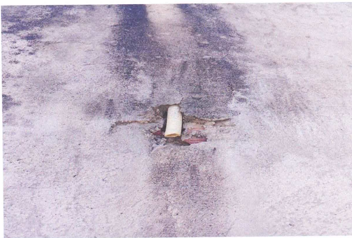
Figura 6 – Eletroduto corrugado exposto. Fonte: elaboração própria
