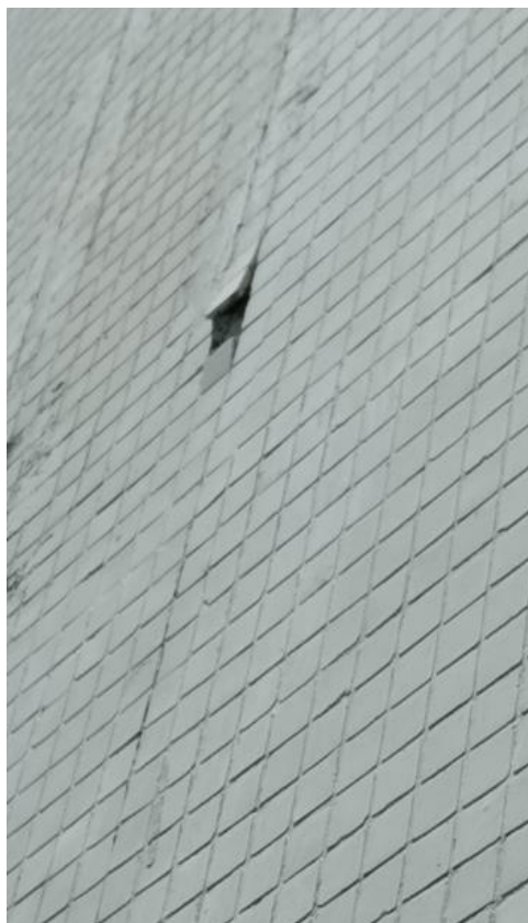
Foto 02 - Deslocamento do revestimento cerâmico
