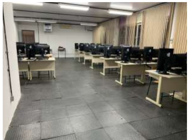
Fig.02. Vista da sala de informática (sala41) piso de borracha danificado e iluminação inadequada.
