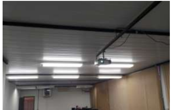
Fig.06. Detalhe das luminárias antigas inadequadas para o ambiente.
