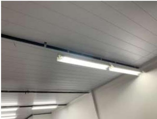
Fig.05. Detalhe da instalação elétrica inadequada, deverá ser refeita a instalação elétrica e instaladas novas luminárias.
