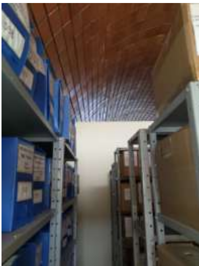
Fig.07. Detalhe da sala do arquivo (sala 44) deverá ser ampliada, instalado forro fibro mineral e refeita a instalação elétrica.
