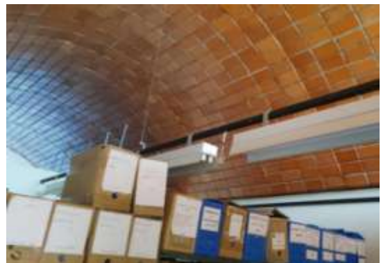
Fig.08. Detalhe da sala do arquivo (sala 44) deverá ser ampliada, instalado forro fibro mineral e refeita a instalação elétrica.
