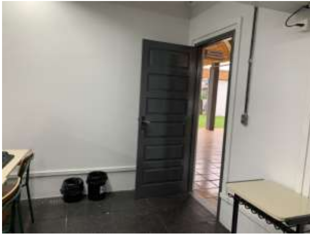
Fig.03. Entrada da sala de informática (sala 41) se encontra com paredes e portas pintadas.
