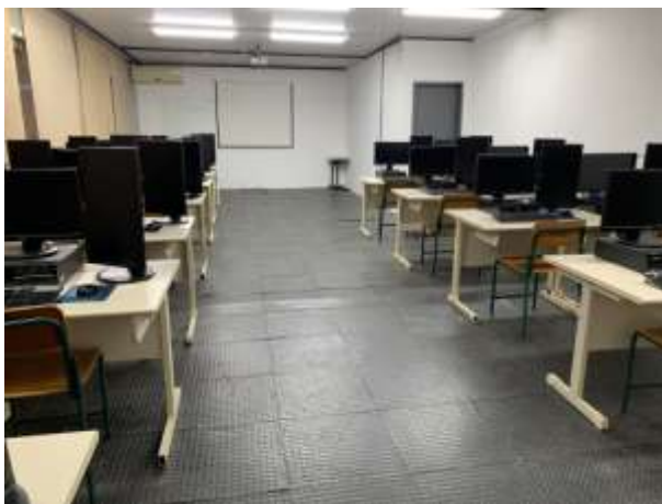
Fig. 01. Vista da sala de informática (sala 41) piso de borracha danificado e iluminação danificada.
