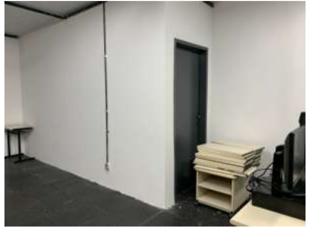
Fig.04. Vista da porta de acesso para sala do arquivo, que deverá demolida para construção de outra sala de informática.
