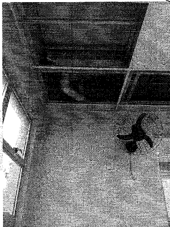
Figura 36: Sistema de calhas com corrosão e forro caído.
