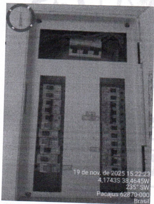
Figura 5: Quadro elétrico não apresenta anomalias visíveis.
