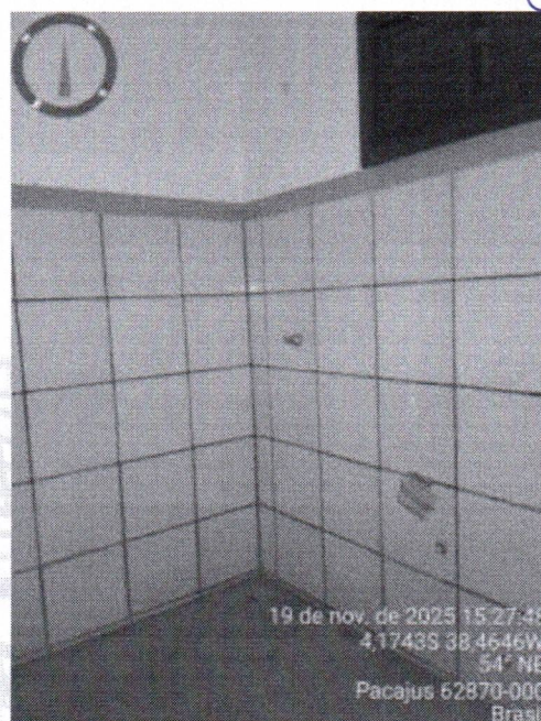
Figura 12: Banheiro de sala de aula.
