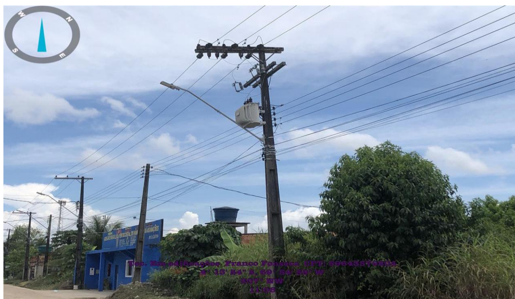
IMAGEM 04 – Vista de um transformador de energia.
