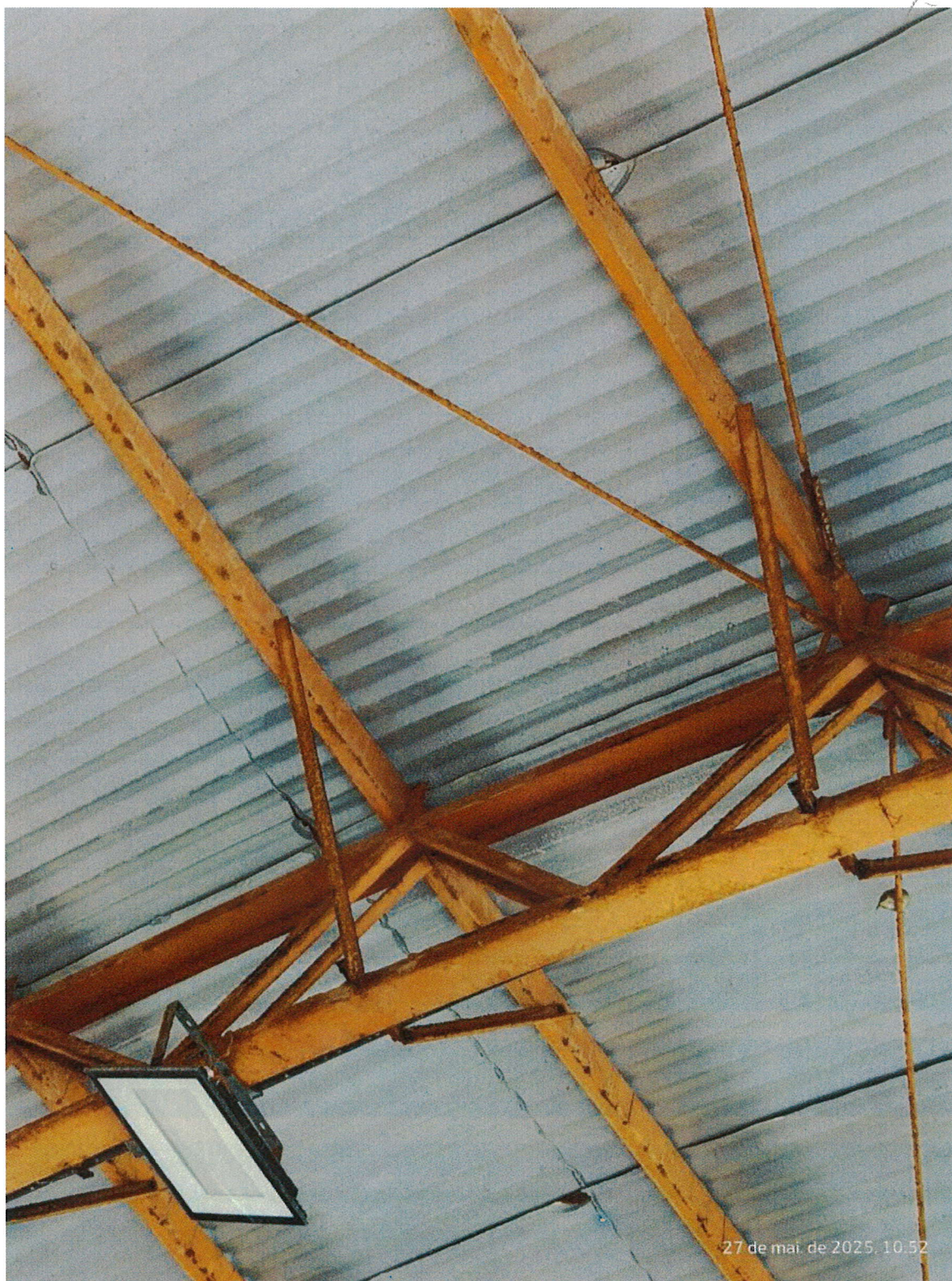
Foto 28: Vista geral das terças e cabos com vários pontos de oxidação.
