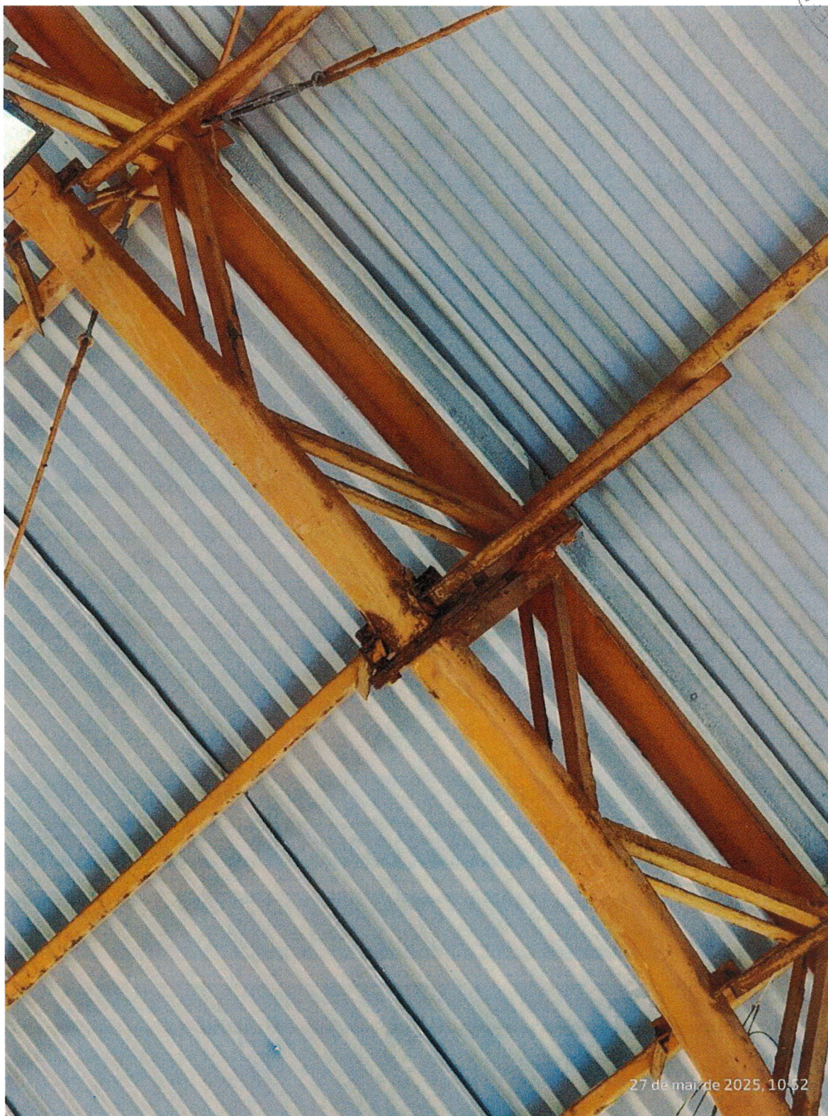
Foto 29: Ligação de emenda com alto grau de oxidação.
