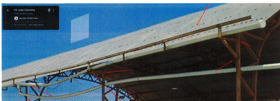
Foto 31: Comprovação da instalação posterior de estrutura de calha instalados inadequadamente, formando ainda, ponto de flexão no sistema treliçado dos pilares.
