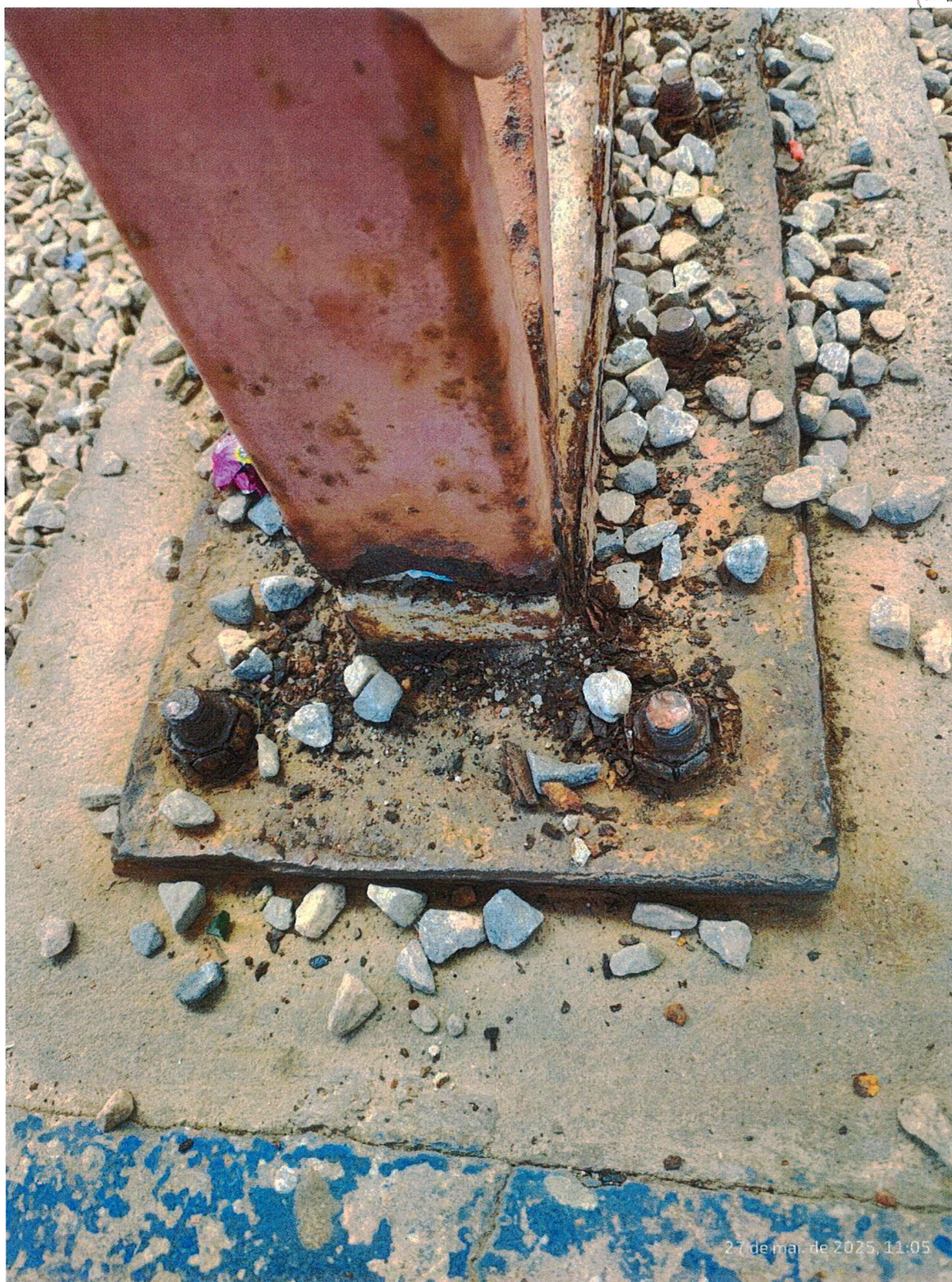
Foto 30: Pilar metálico com rompimento de banzo.
