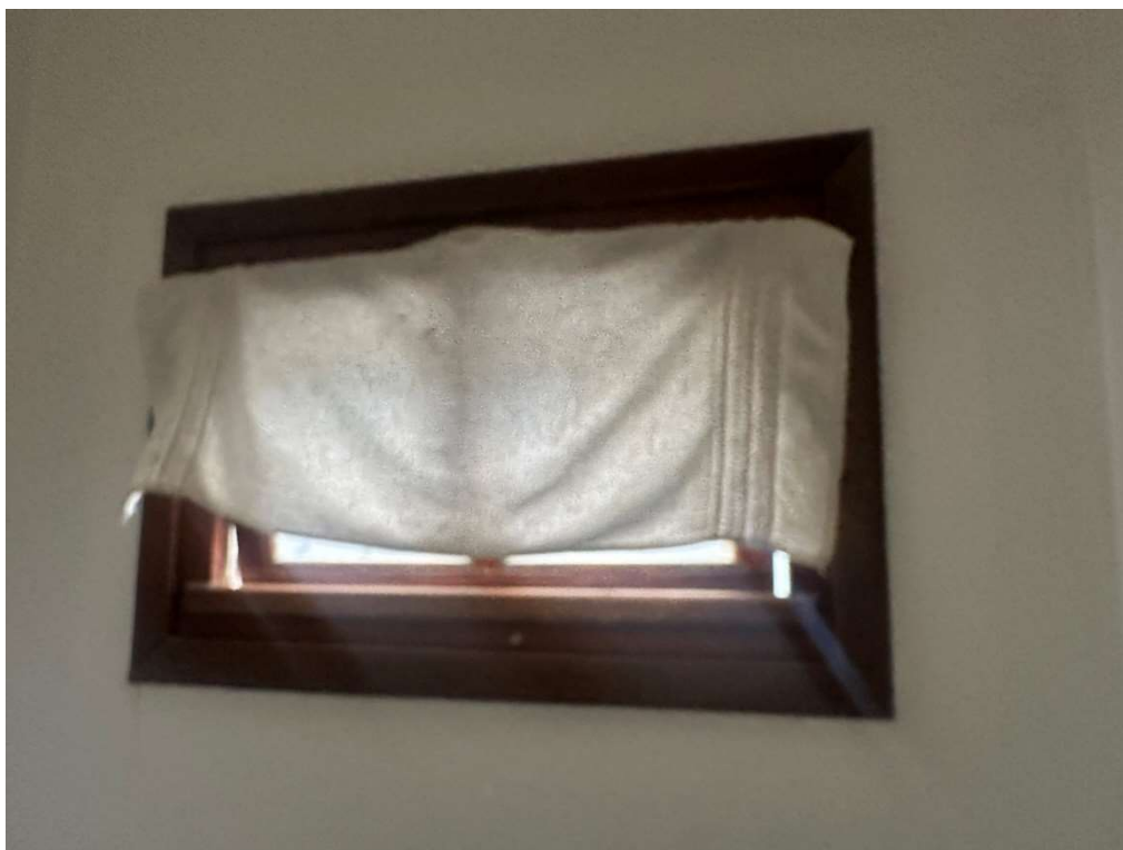
Figura 8 – JANELAS SEM PROTEÇÃO SOLAR
