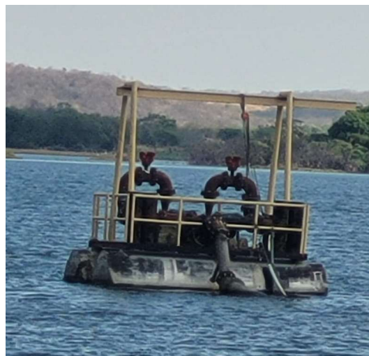
Figura 6 - Captação Existente (Flutuante)
