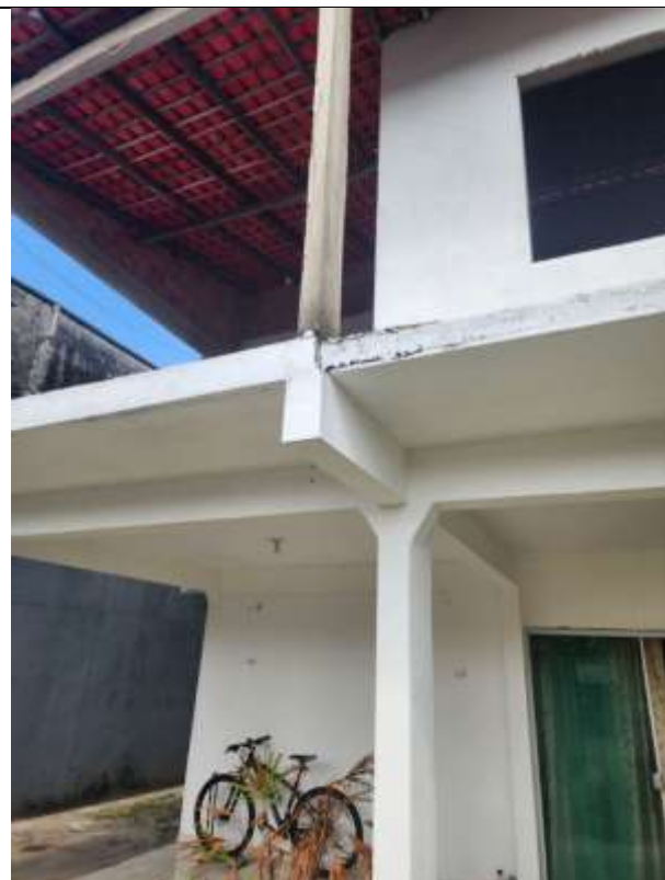
Foto 09: Fissura da laje e falta de recobrimento da laje
