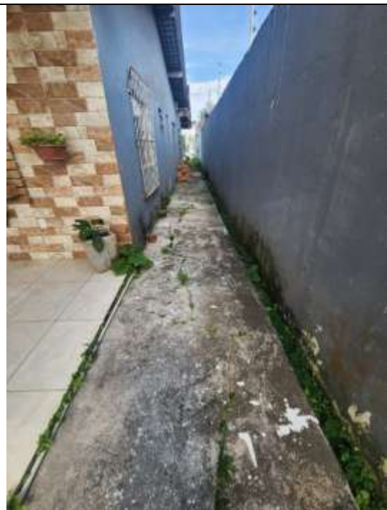
Foto 04: Corredor lateral direito com fissuras
