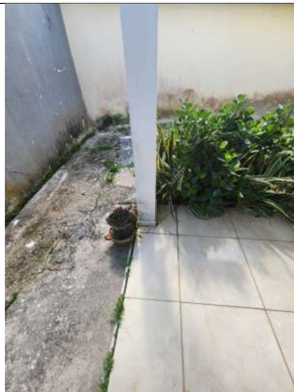
Foto 05: Fissuras no pátio possível recalque do solo
