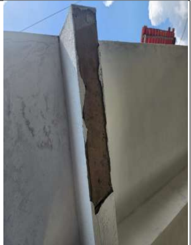
Foto 14: Deslocamento do reboco
