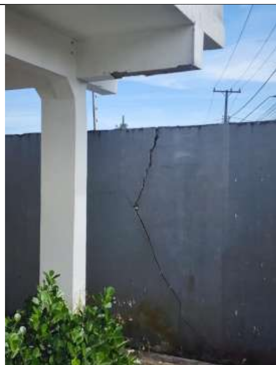
Foto 07: Rachadura no muro
