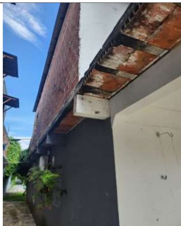
Foto 08: Deslocamento de concreto de viga
