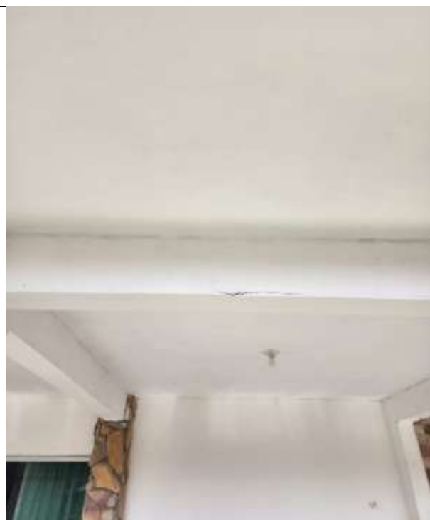
Foto 12: Fissura na laje
