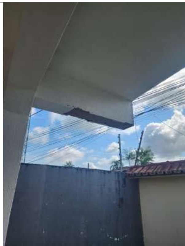
Foto 15: Deslocamento de reboco, concreto e ferragem aparente
