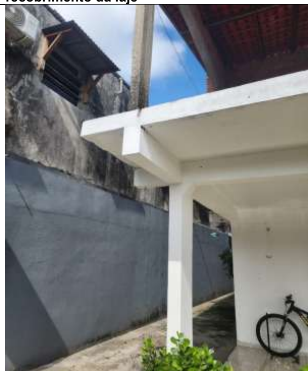
Foto 11: Fissura na laje e falha no recobrimento da viga
