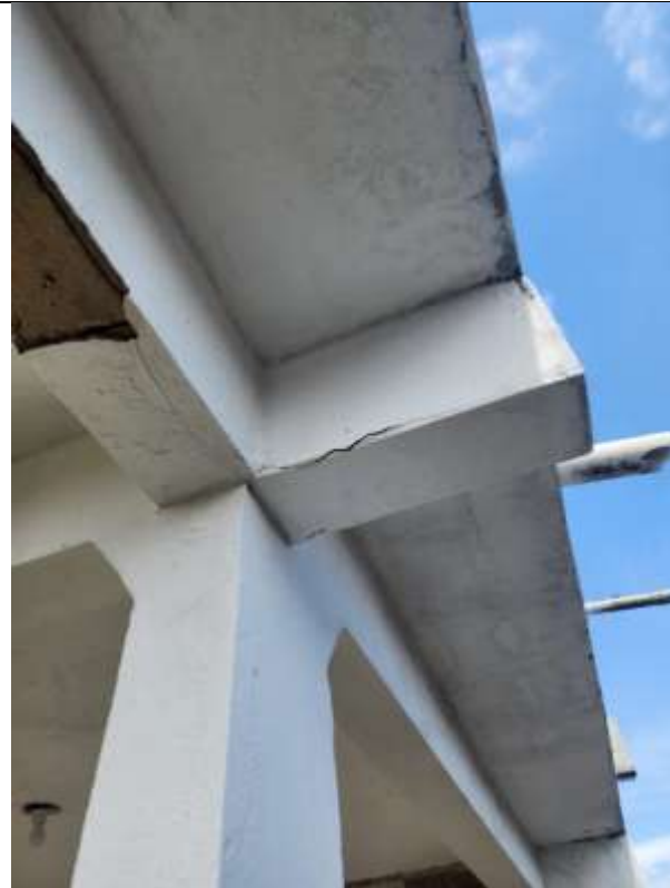
Foto 13: Fissura da Viga
