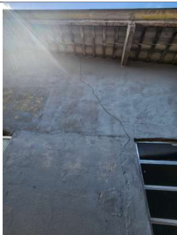
Foto 06: Fissura na parede na lateral direita
