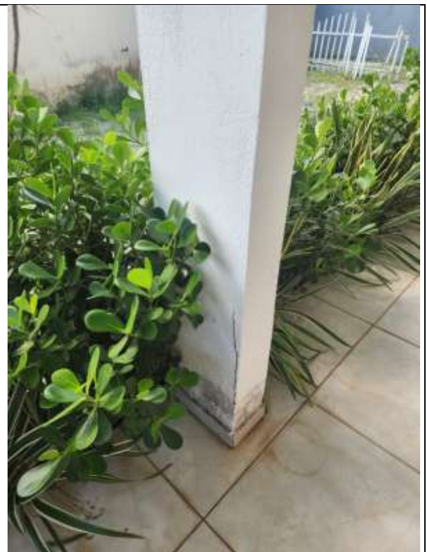
Foto 16: Fissura em pilar
