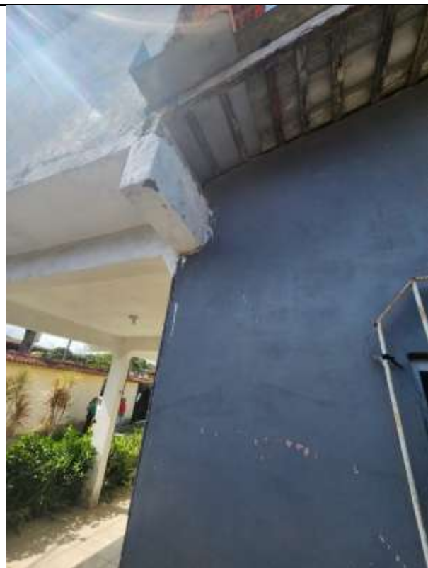
Foto 10: Deslocamento de concreto da viga
