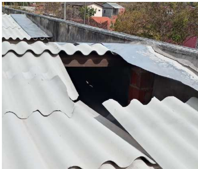
Telhas a serem trocadas.
