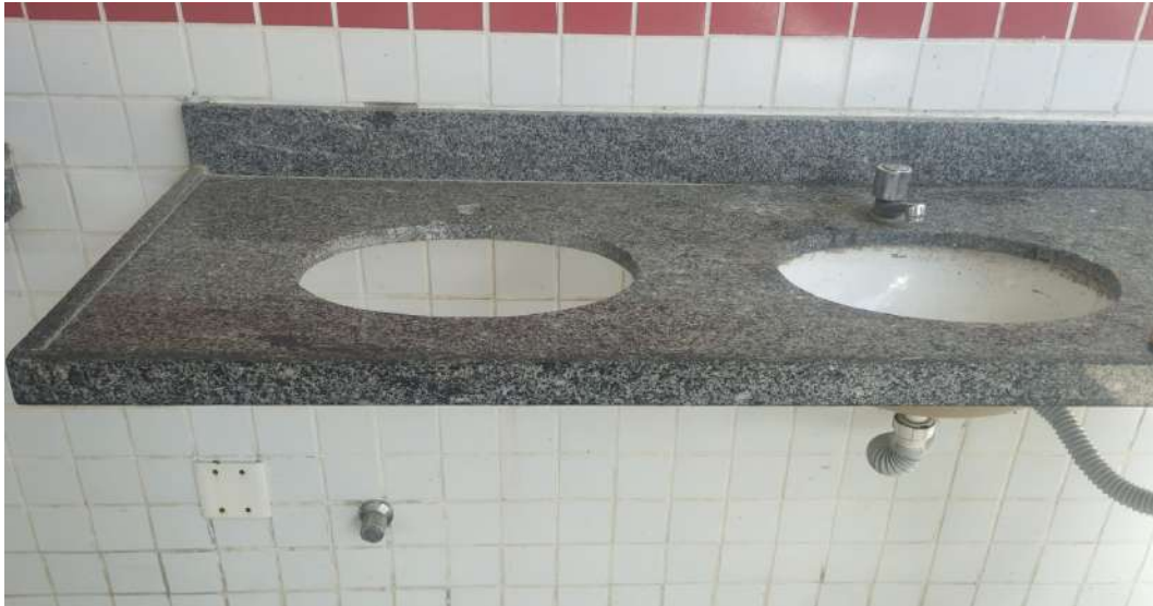
Pia para instalar cuba e torneira que estão faltando.
