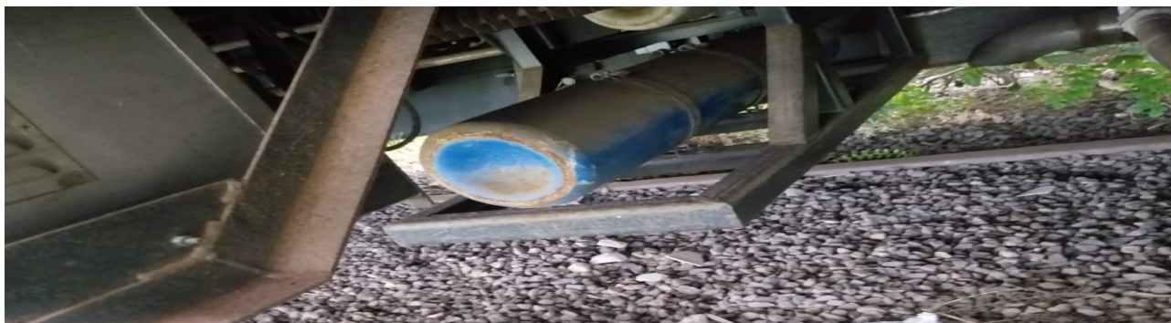
Figura 9 – Sistema anti-incêndio, cilindro e sinais de ferrugem. Fonte: Edital do Leilão de Macaé/RJ
