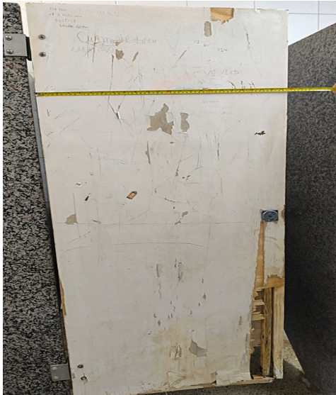
SUBSTITUIÇÃO E INCLUSÃO DAS QUE ESTÃO FALTANDO (6 UNIDADES) 60 X 150 CM
