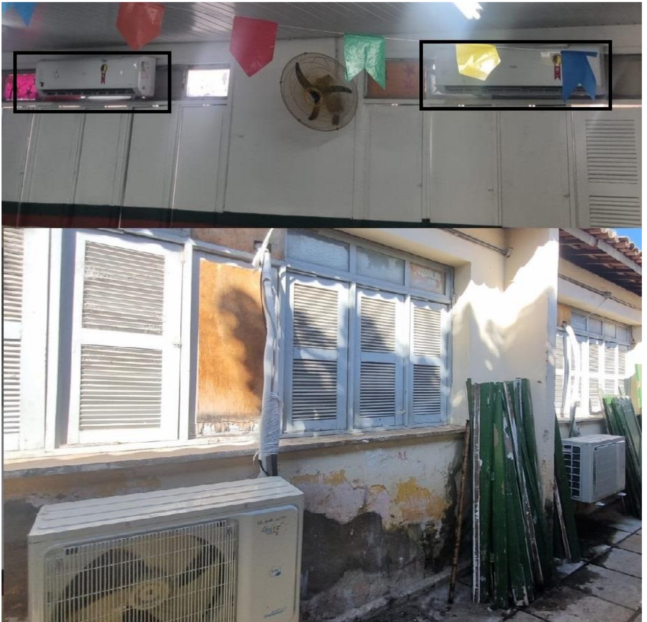
Foto 04: Duas maquina de 24000Btus a ser desinstalada e instalada na sala do 2ª ano D.
