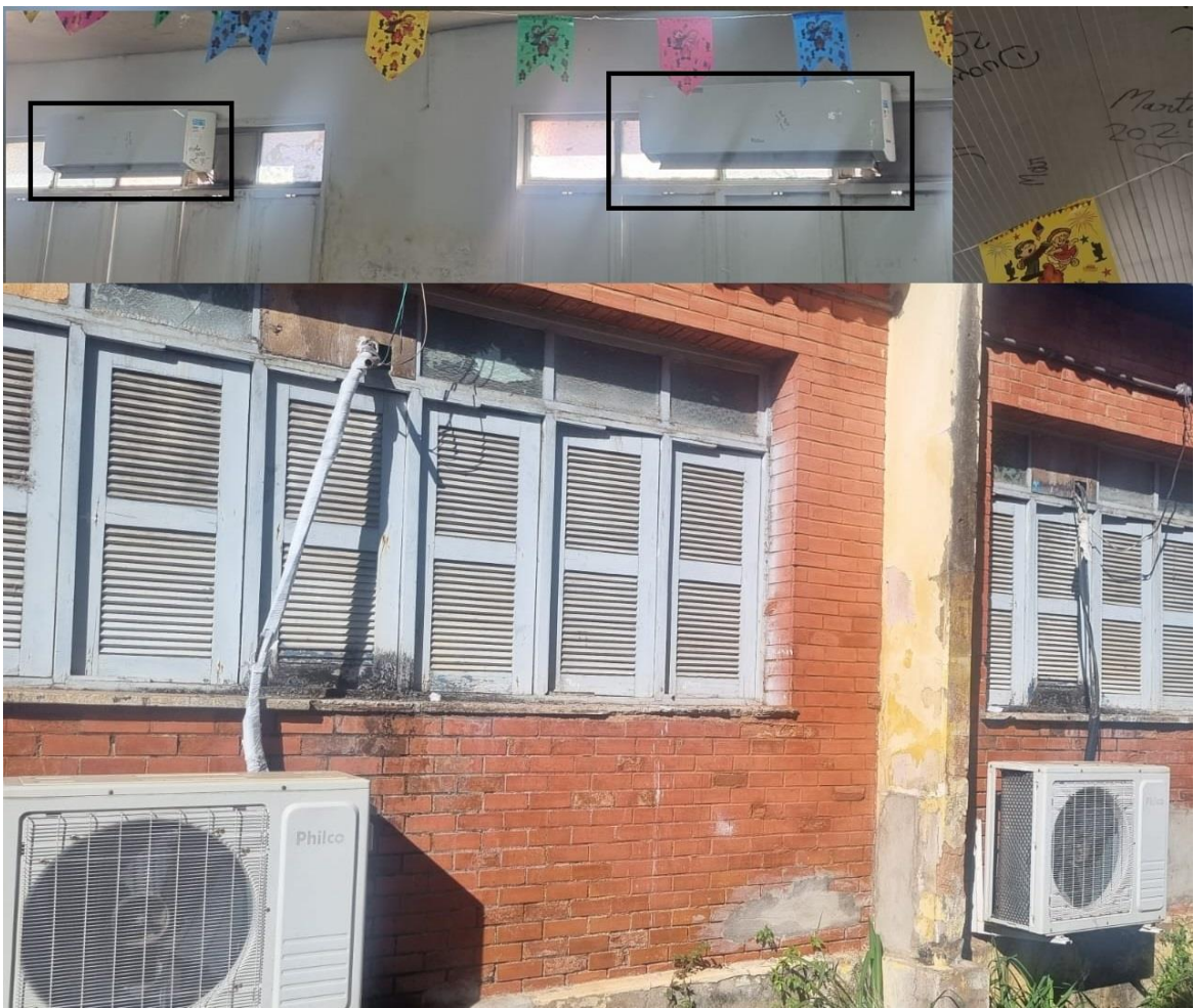
Foto 03: Duas maquina de 24000Btus a ser desinstalada e instalada na sala do 2 a ano B.
