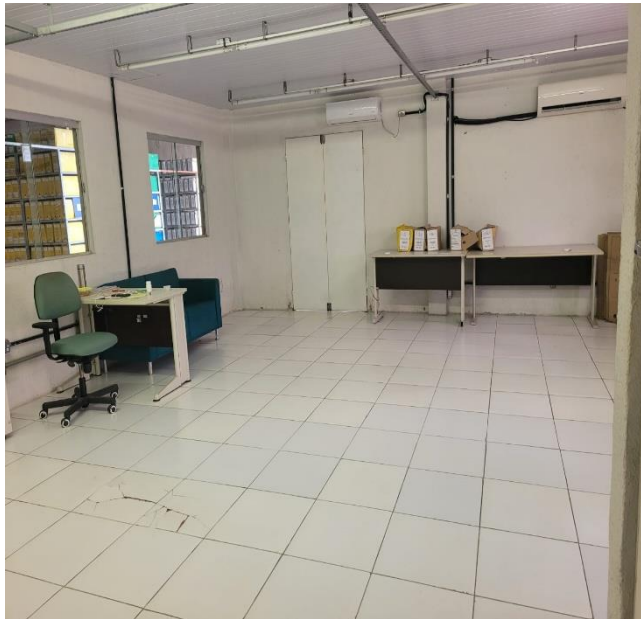
Figura 4 - Espaço disponível na Sala Técnica
