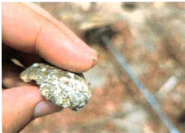
Foto 4 – Detalhe do corpo de prova retirado
