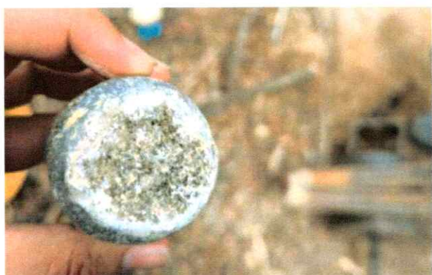
Foto 5 – Detalhe do corpo de prova retirado
