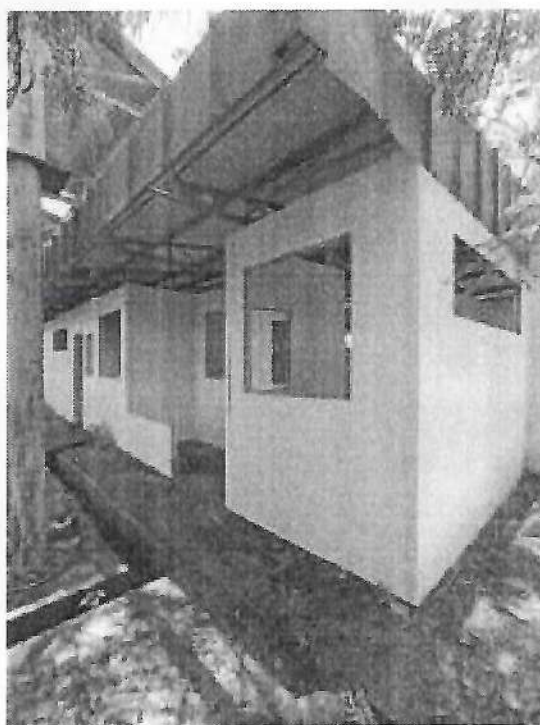
Figura 18 – Ausência de esquadrias. Fonte: elaboração própria.
