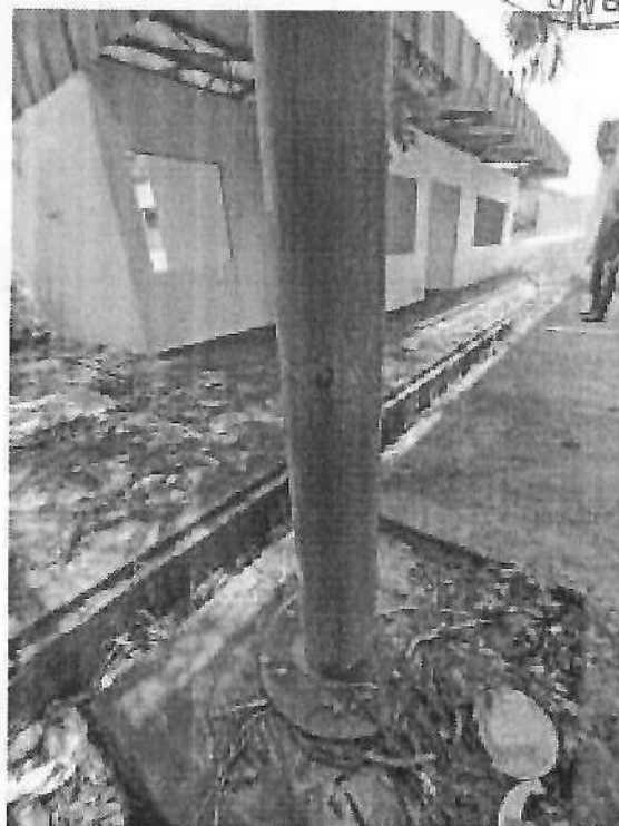
Figura 23 – Oxidação na estrutura da cobertura. Fonte: elaboração própria.
