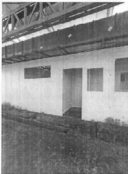
Figura 24 – Ausência de esquadrias. Fonte: elaboração própria.
