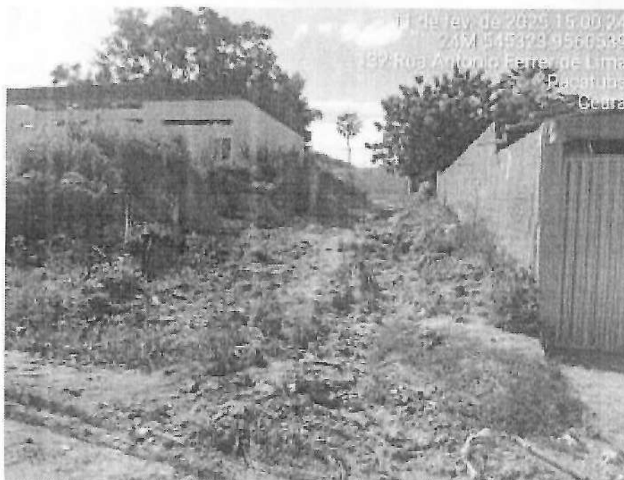
Figura 6 – Erosão no recuo lateral. Fonte: elaboração própria
