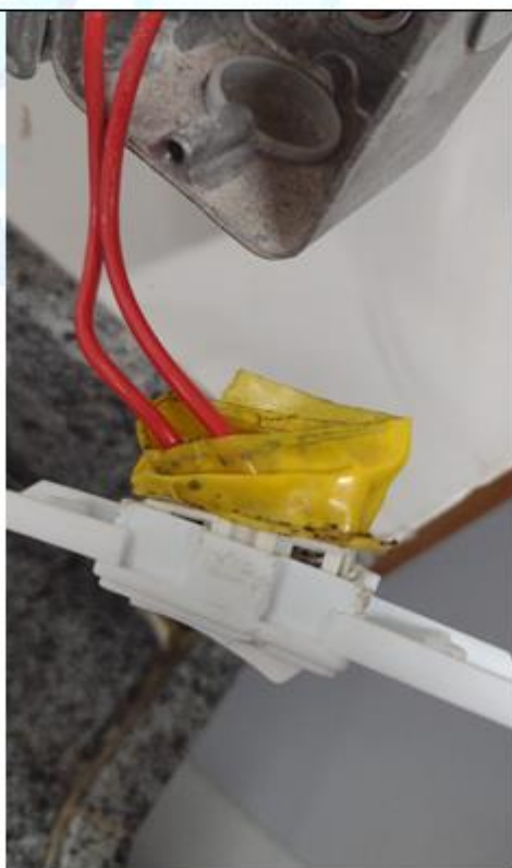
Foto 12 – Interruptor 1 tecla BWC
