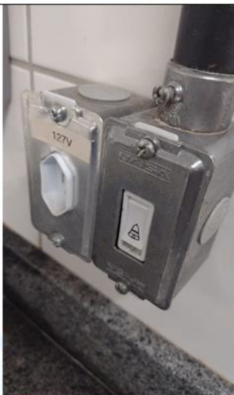
Foto 11 – Interruptor 1 tecla BWC
