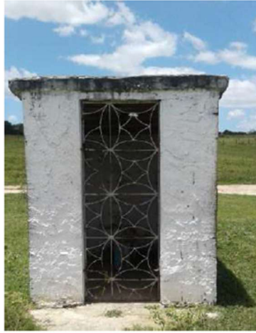
Figura: Poço existente de água salobra localizado na comunidade de Cacimba Salgada para atendimento da citada e a comunidade Barbaço, ambas situadas no município de Brejinho/RN.
