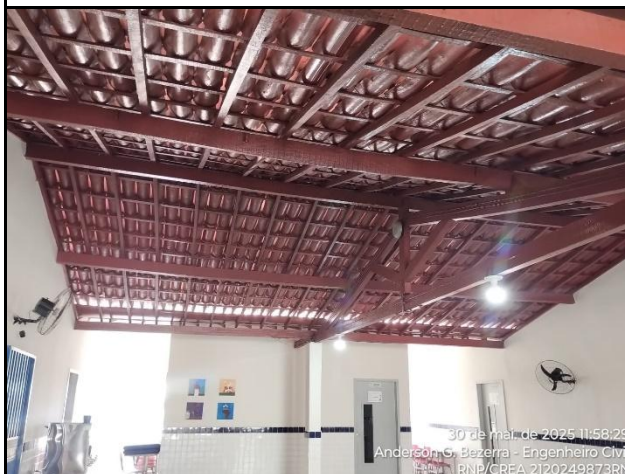
Foto 07: Telhamento - a ser substituído
