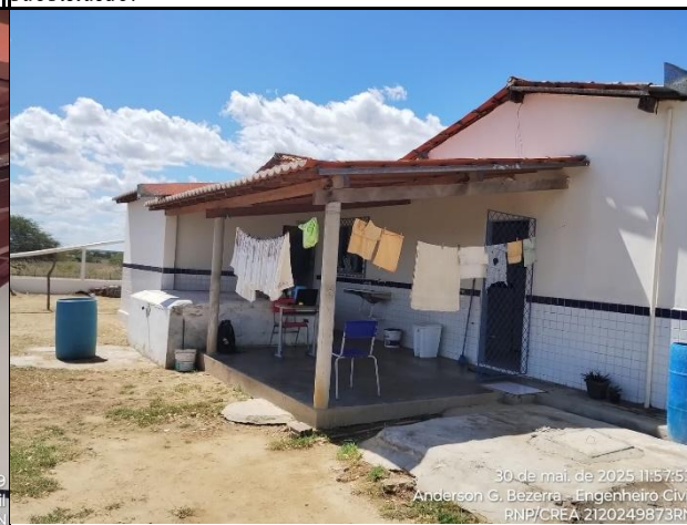
Foto 08: Área de serviço e antiga fossa séptica - a desativar, aterrar e compactar.
