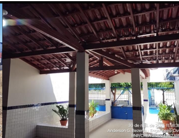
Foto 06: Entrada que dá acesso à escola e telhamento a ser substituído.
