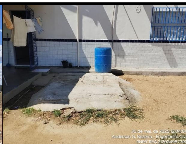
Foto 02: Antiga fossa séptica - à desativar, aterrar e compactar.
