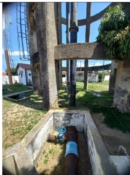
Imagem 02: tubulação de saída (distribuição) do reservatório elevado, que através de derivação alimentará a EERP 01.
