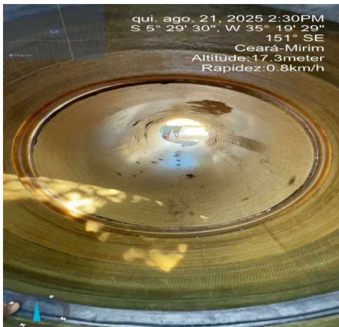
Figura 3 - Interferência entre conexão e tubulação
