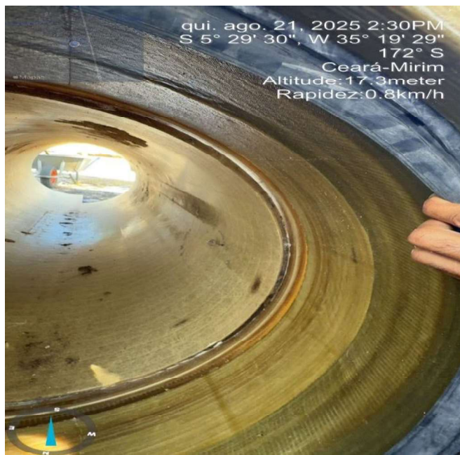
Figura 4 - Interferência entre conexão e tubulação
