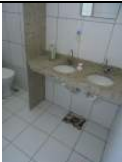
Foto 37: Sanitário coletivo: Ausência de cabide e porta-objetos junto aos lavatórios e boxes. Os lavatórios não possuem barras de apoio. Torneira de giro.
