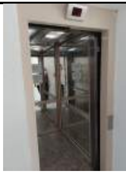
Foto 82: Sinalização: Não existe sinalização tátil com instruções de uso do lado externo do elevador. Ausência de sinalização tátil de alerta e do número do pavimento, em relevo e em Braille.
