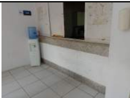
Foto 79: Mobiliário: O balcão de atendimento da copa não permite o avanço de pessoas em cadeira de rodas sob o tampo, pois possui altura livre sob o tampo de 1,01m, altura total de 1,03m e profundidade livre de 1cm.
