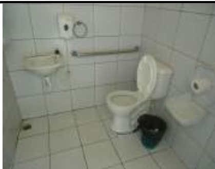
Foto 38: Sanitário acessível: A localização do lav. compromete o espaço para transferência para a bacia sanitária. Ausência de barras retas posicionadas vert. na parede lateral à bacia sanitária e horiz. na parede de fundo, de barras de apoio instaladas na altura do lavatório. Torneira de giro. Ausência de alarme de emergência, de porta-objetos e cabide. A papelaria de sobrepor irregular.
