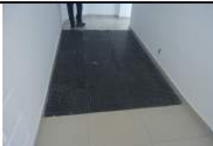
Foto 84: Circulação: rampa: Não há corrimão duplo, de ambos os lados, com seção circular e prolongamento mínimo de 0,30m. Ausência de sinalização tátil e visual de alerta indicando o início e o término da rampa.
