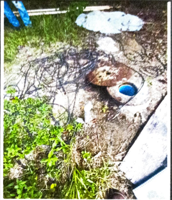
Foto 2: Cabo PP 3x2,5mm circundado o poço artesiano.
