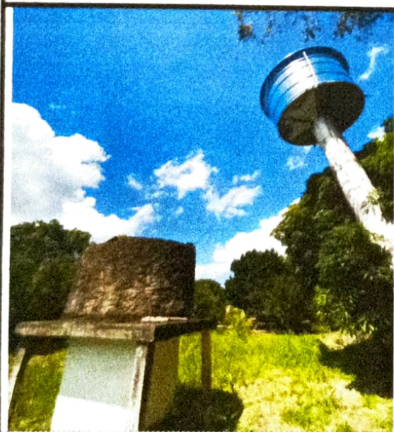
Foto 7: Conexão da casa de bombas com boia elétrica comprometida.
