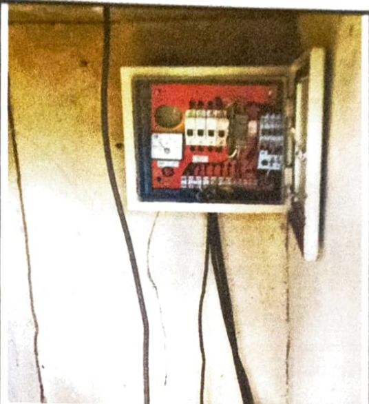
Foto 6: Quadro de comando (Acionamento bomba submersa).
