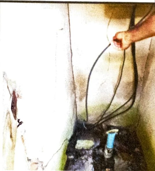
Foto 8: Cabo de conexão com boia elétrica rompido.
