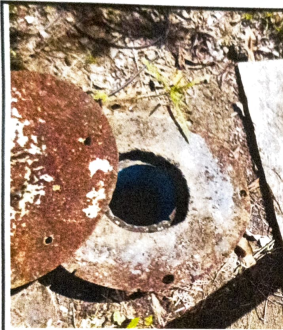
Foto 1: Poço artesiano com ausência da bomba submersa.
