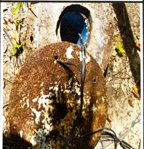
Foto 4: Cabo PP 3x2,5 mm com diversos sinais de emendas.
