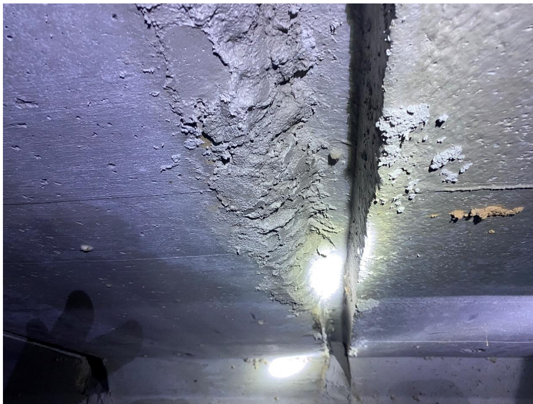
Figura 06: Reparos de forma desconforme com o determinado pela fiscalização.
