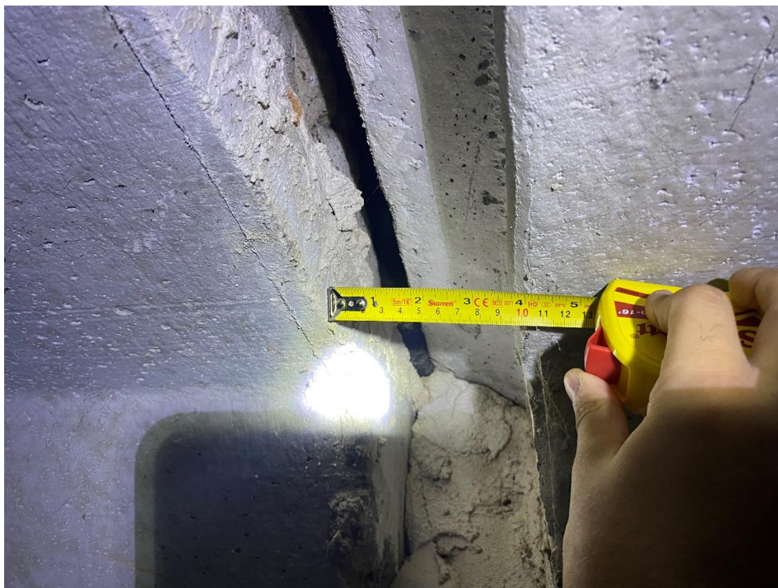
Figura 05: Locais com aberturas de rejuntamento de tamanho inadmissível.
