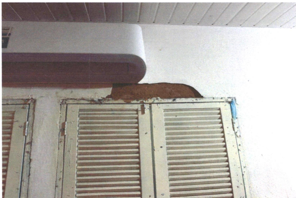
Imagem 13 – Pintura de parede interna de cor branca danificada e desgastada
