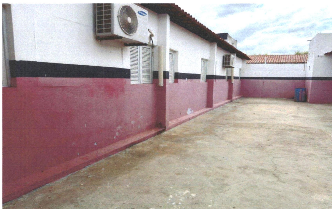
Imagem 10 – Pintura de parede externa de cor branca e vermelha danificada e desgastada
