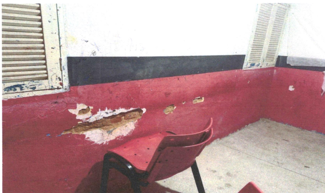
Imagem 12 – Pintura de parede interna de cor branca e vermelha danificada e desgastada
