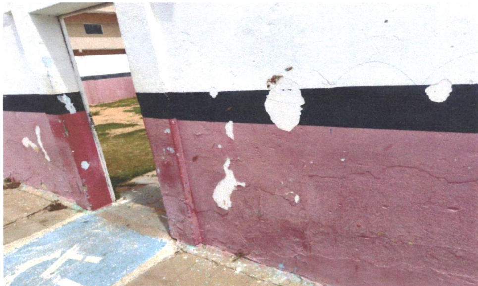
Imagem 04 - Desgaste de pintura de muro de fachada da edificação
