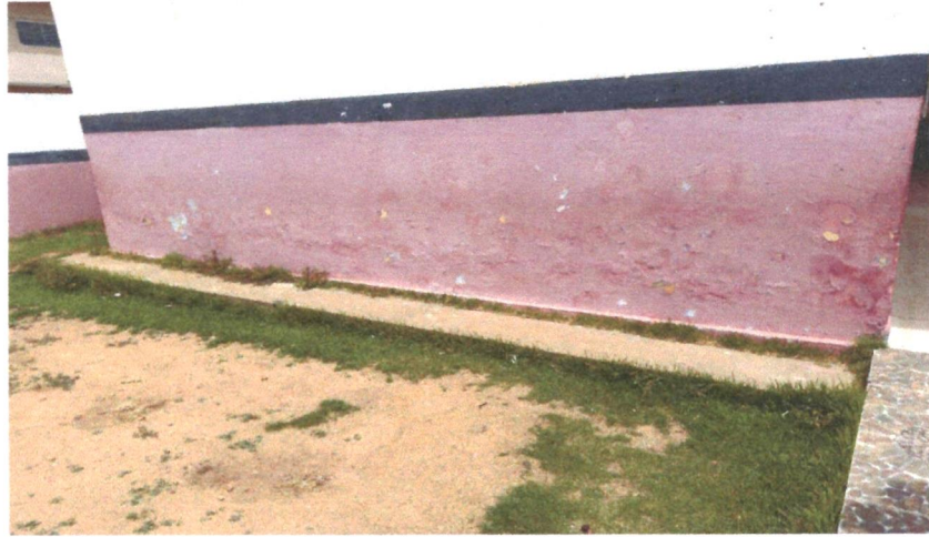
Imagem 01 - Desgaste de pintura de parede
