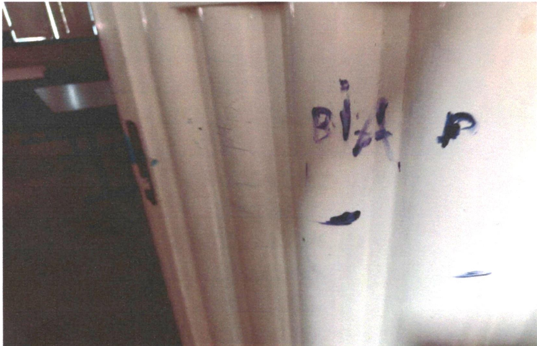
Imagem 07 – Pintura de porta metálica de cor branca danificada e desgastada
