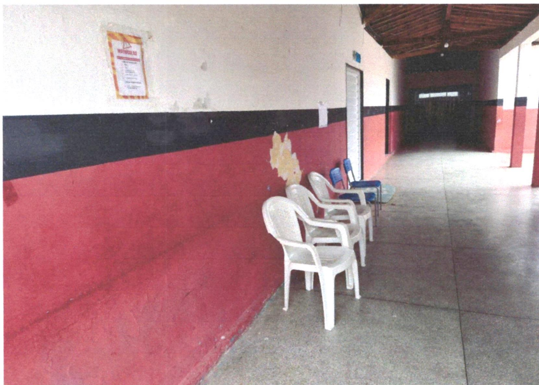
Imagem 11 – Pintura de parede interna de cor branca e vermelha danificada e desgastada
