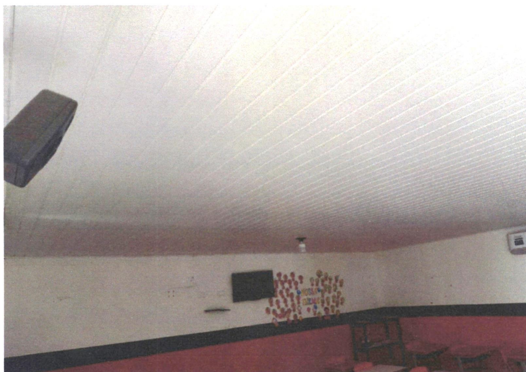
Imagem 14 – Forro com empenamento
