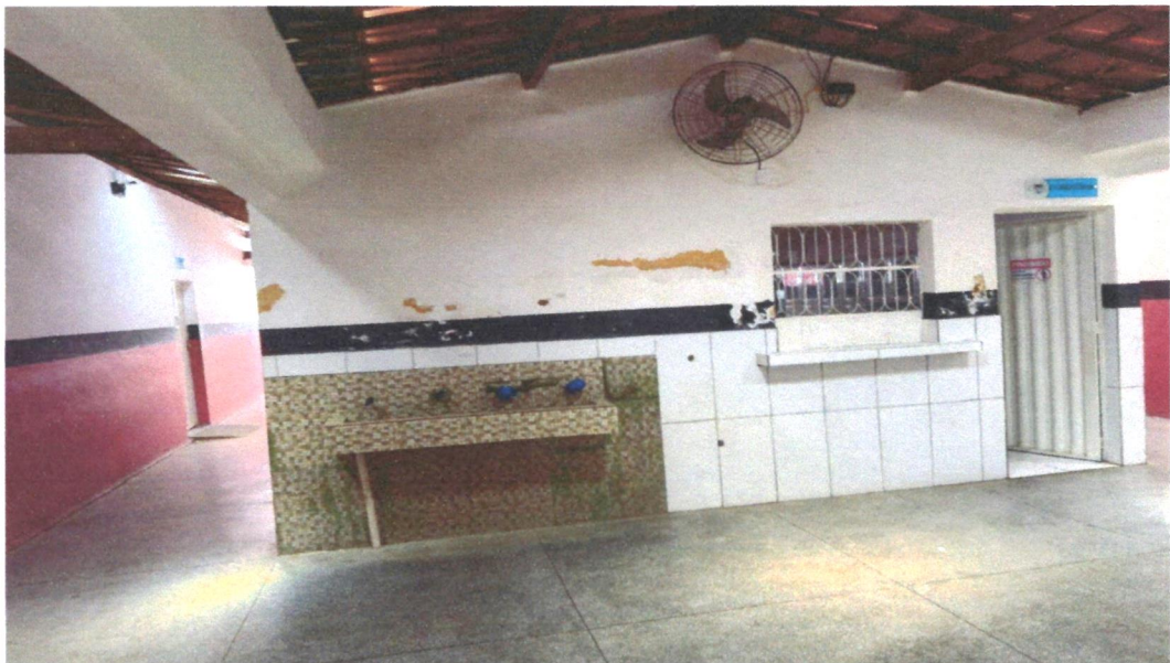
Imagem 06 - Desgaste de pintura e fissuração de parede interna da edificação
