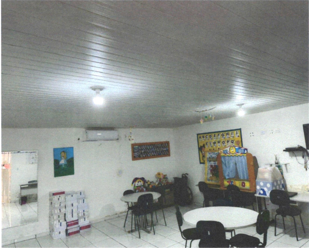
Imagem 15 – Forro com empenamento
