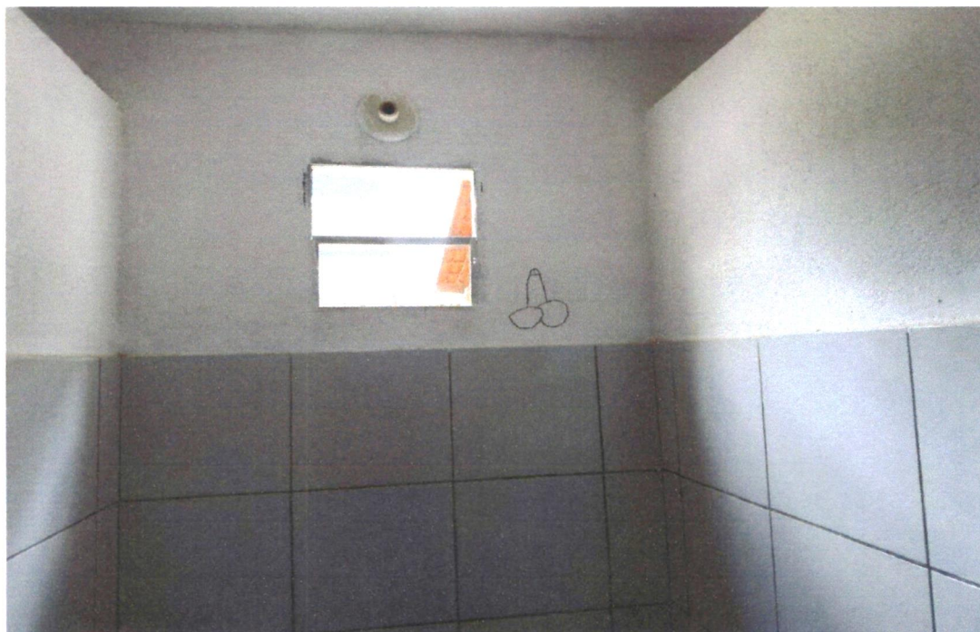
Imagem 09 – Pintura de parede interna de cor branca danificada e desgastada
