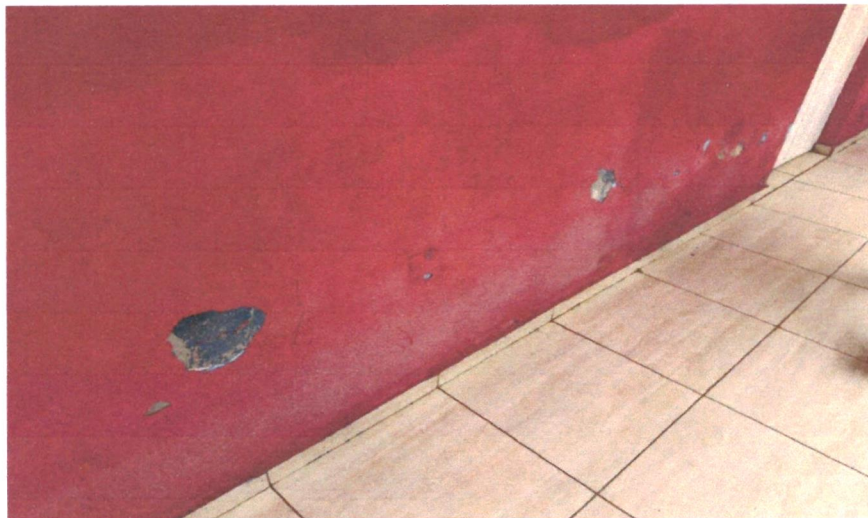
Imagem 02 - Desgaste de pintura de parede interna da edificação
