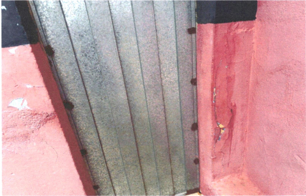
Imagem 05 - Desgaste de pintura e fissuração de parede interna da edificação
