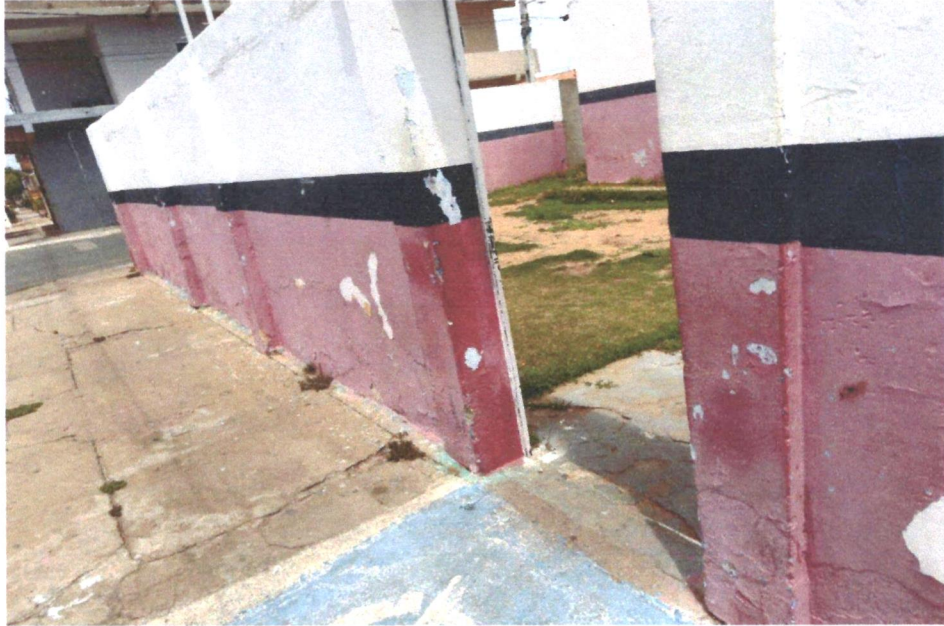
Imagem 03 - Desgaste de pintura de muro de fachada da edificação
