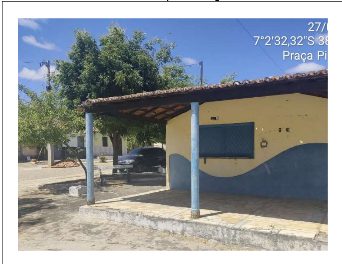
Quadro 1: Pisos e pinturas desgastados
