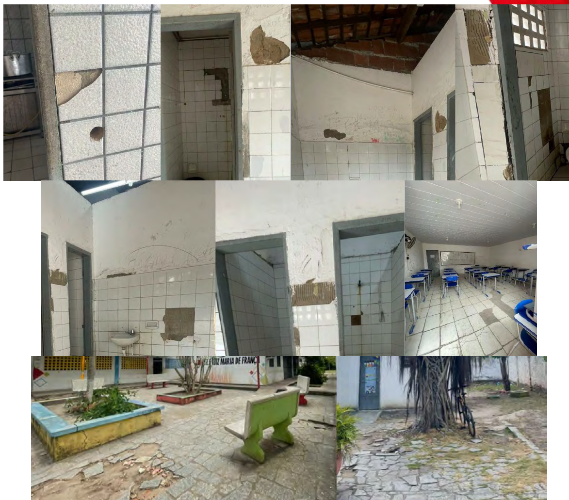
Figura 5 – Revestimentos de parede e piso deteriorados
